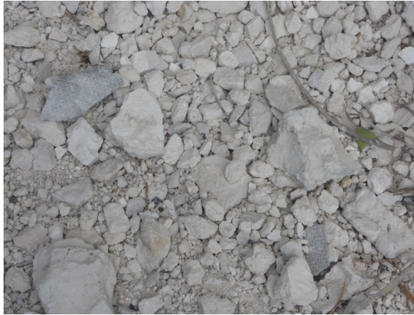
Imagen 1-Observaciones. Se detectan dos trozos de placa de fibrocemento en el patio mirador de Benigànim precipitados desde la cubierta.
