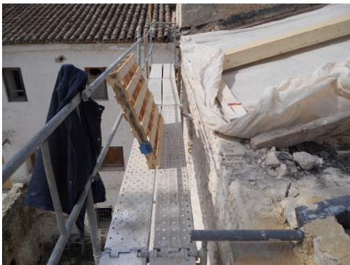
Imagen 1-Observaciones. Acopio de material en la última planta del andamio entorpeciendo el paso.
