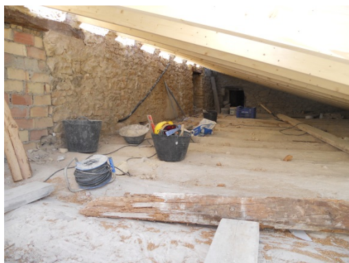
Imagen 1-Observaciones. Acopio de material bajo cubierta.
