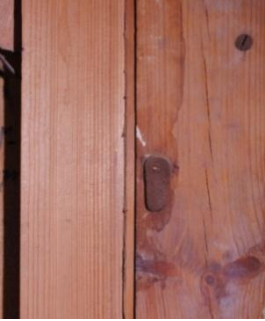
Detalle cerco de humedad de reverso.
