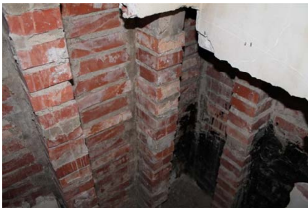
Fig. 49: Muro de cerramiento sin aislamiento térmico. Apertura de la cámara.
