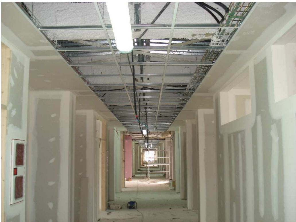
Bandeja perimetral y falso techo desmontable en pasillo de secundaria
