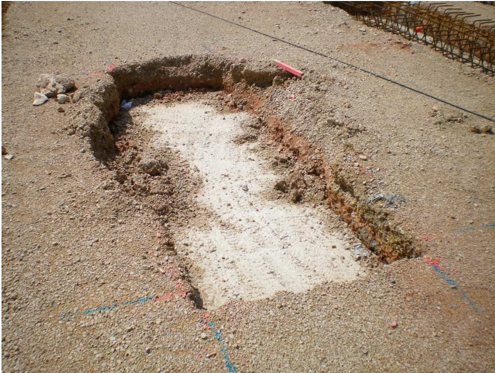
Relleno de zanja de cimentación para apoyo de escalera hasta cota de cimentación con hormigón de limpieza
