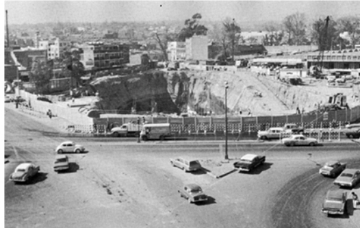
11. Excavación para la construcción de la línea 1 del metro. Fuente: Memoria del Metro de la Ciudad de México.
