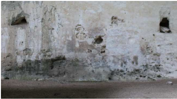
Figura 64. Humedades en el muro norte del Cuarto 4.
