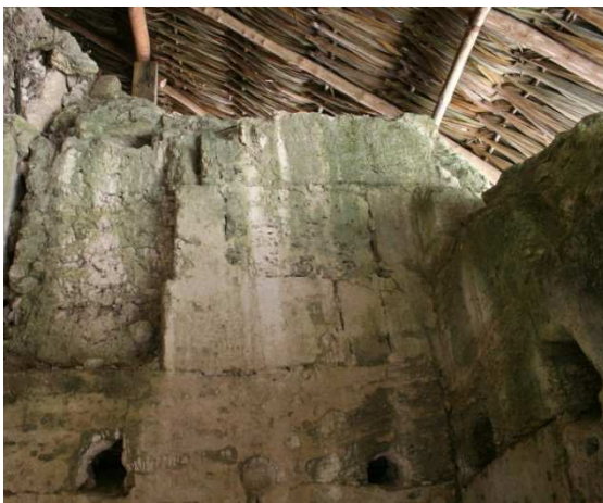
Figura 77. Concreciones biológicas debidas a la filtración de agua en el Cuarto 7.
