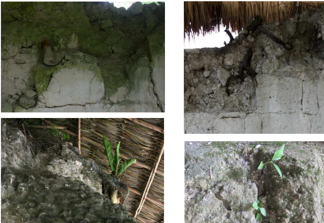
Figuras 79, 80, 81 y 82. Detalle de la presencia de vegetación y raíces en los muros.
