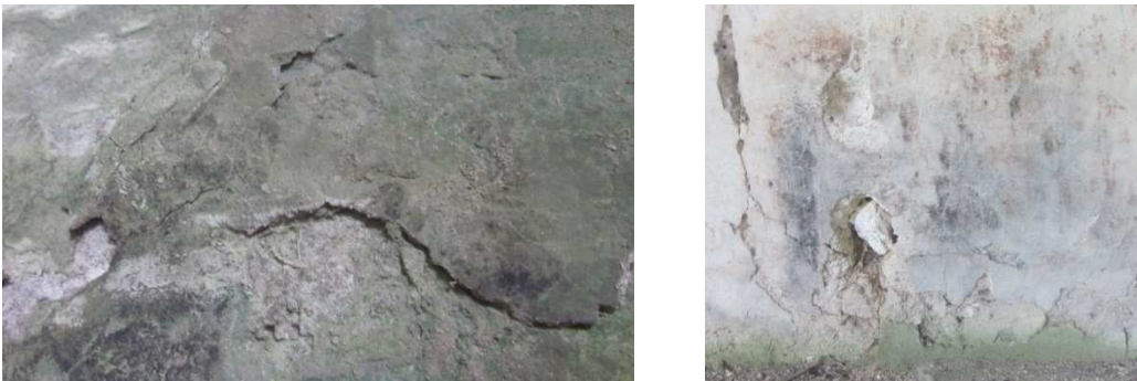
Figuras 68 y 69. Abolsamientos, laminación y fisuración de los estucos.
