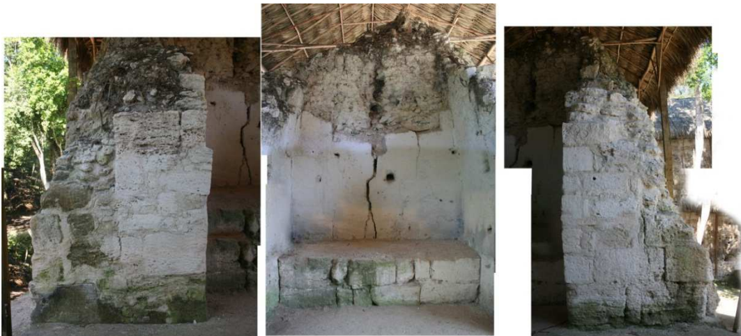
Figura 94. Estado actual de conservación del muro norte de Cuarto 10.
