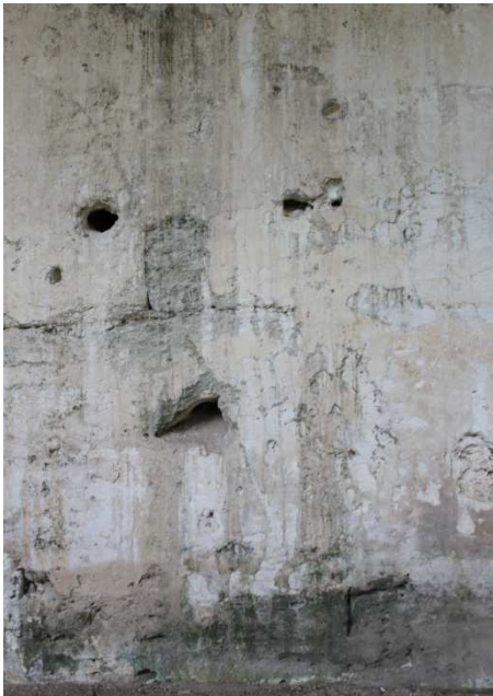
Figura 75. Pátinas de suciedad producidas por las escorrentías en el Cuarto 4.
