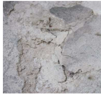
Figura 65. Laminaciones y disgregación de la capa de estuco.
