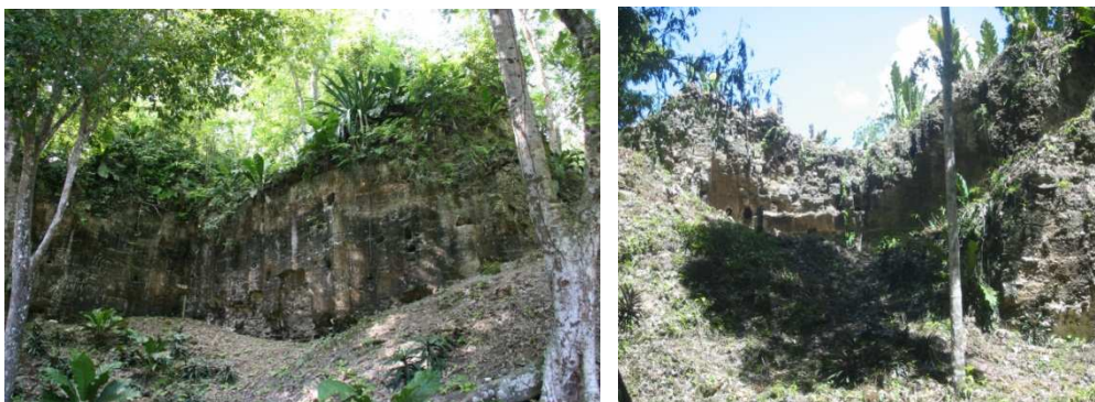
Figuras 58 y 59. Estado inicial en el que se encontró los palacios de La Blanca. Fotografía PLB.
