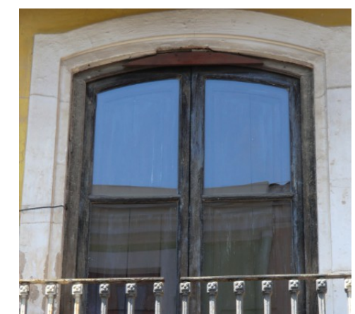
Fotografía 16: Envejecimiento de carpintería exterior
