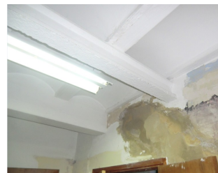
Fotografía 5: Refuerzo existente de forma inadecuada en forjado
