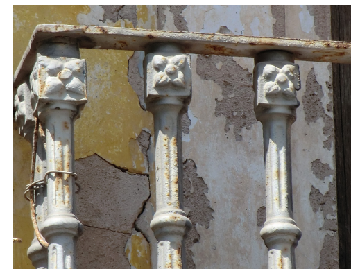
Fotografía 18: Presencia de óxido en barandilla de hierro
