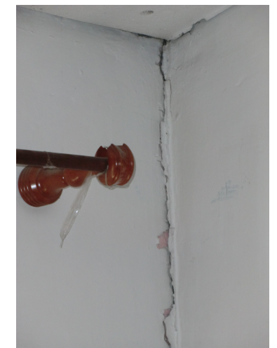
Fotografía 11: Grieta estabilizada en esquina interior
