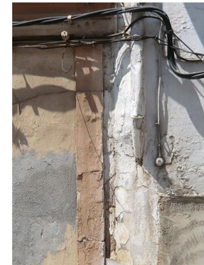
Fotografía 13: Posibles síntomas de humedad accidental en bajante
