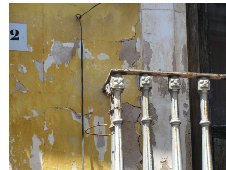
Ilustración 15: Desprendimientos de pintura y fisuras en fachada
