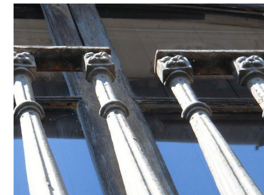
Fotografía 19: Pérdida de elemento de barandilla
