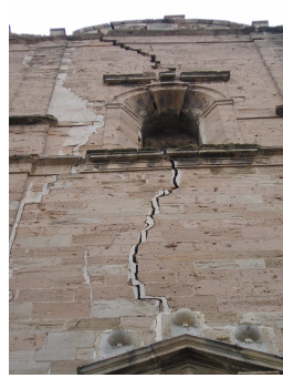
FACHADA STA. MARÍA (GRIETA)
