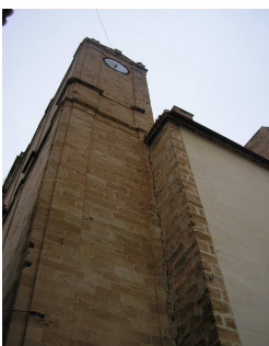
GRIETA ENCUENTRO FACHADAS
