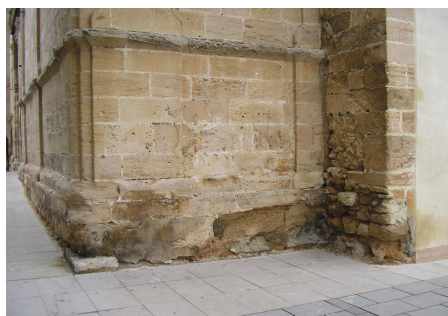
SILLARES DETERIORADOS EN LA BASE (PLZ. AYUNTAMIENTO)
