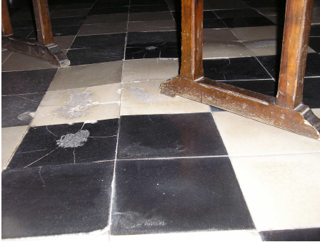
PAVIMENTO AFECTADO POR LAS PATOLOGÍAS
