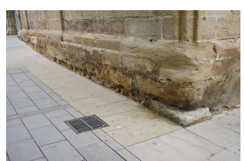
SILLARES DETERIORADOS EN LA BASE (C/ STA. MARÍA)
