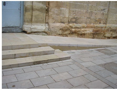
C/ STA. MARÍA (RAMPA ACCESO – SILLARES DETERIORADOS)
