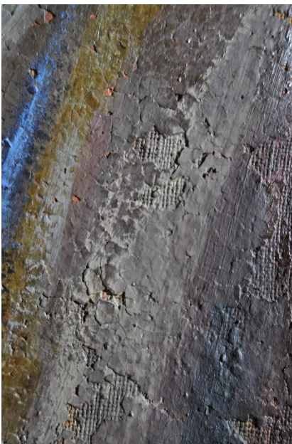
Fig. 27 Imagen que muestra el estado de la película pictórica, debido, entre otras cosas, al deteriorado estado de la capa de preparación
