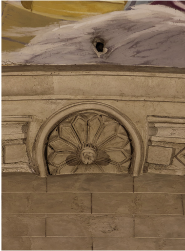
Fig. 22. Faltantes del muro
