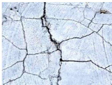
Fig. 6 Craqueladuras causadas por la humedad relativa.
