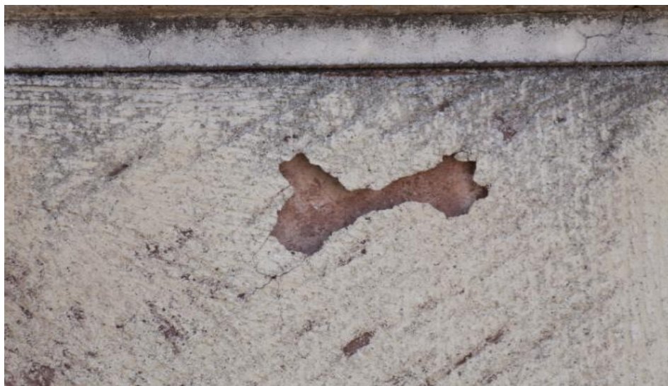
Imagen 14. Laguna que afecta a la última capa de revoque.
