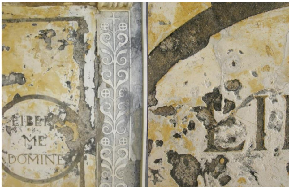
Imagen 11. Detalles de los deterioros de este esgrafiado.
