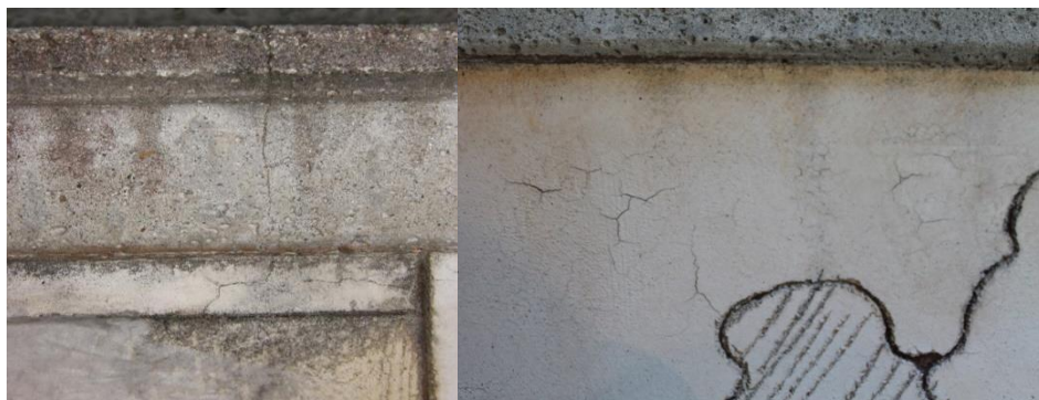
Imagen 15. Detalles de algunas grietas.
