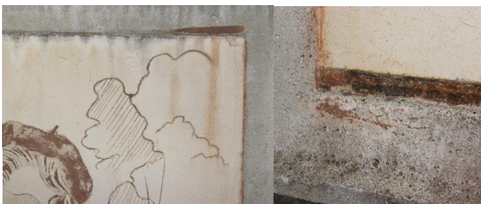
Imagen 18. Cercos de humedad debajo del marco y mancha del pigmento del mortero.
