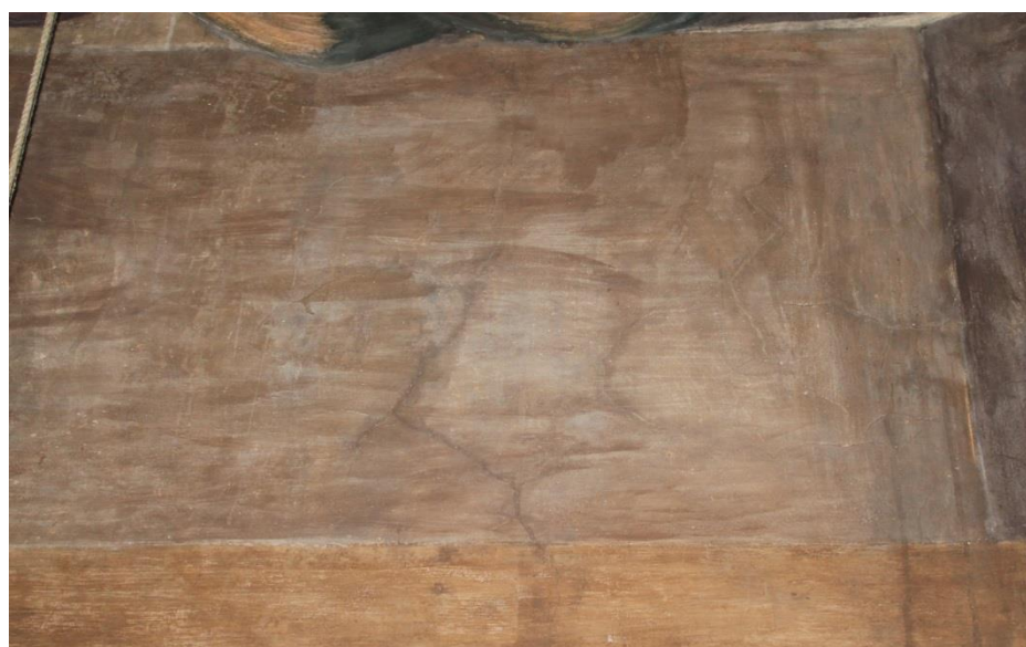
Fig. 12. Vista de detalle de grietas consolidadas.
