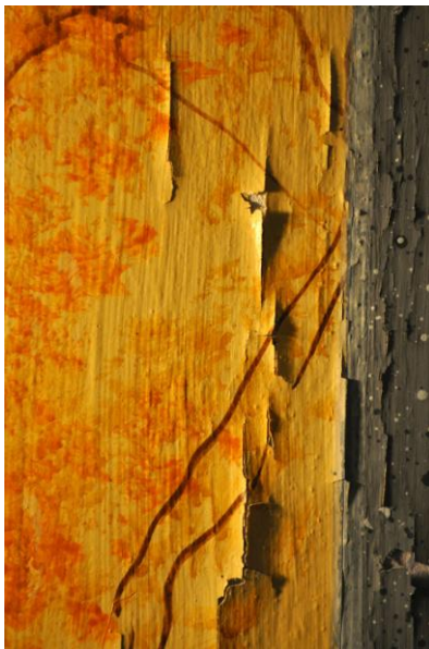
Figura 48. Escamas en los pilares.
