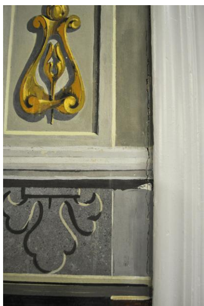
Figura 30. Grieta alrededor de la puerta.
