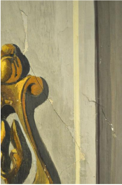
Figura 34. Fisura en ornamentación.
