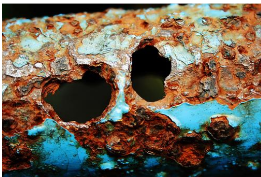
Figura 6: Corrosión en el acero
