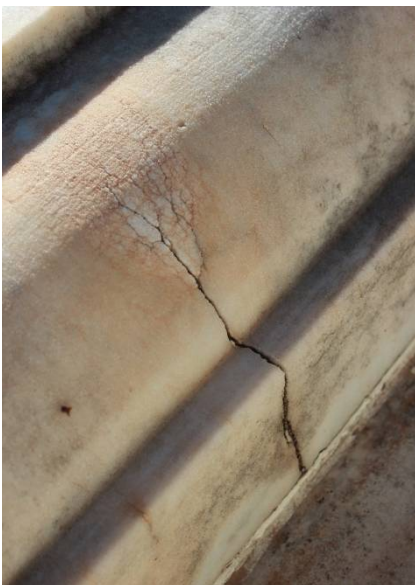
Fig. 22. Ejemplo de grieta en la superficie del panteón. (Fotografía de autor)
