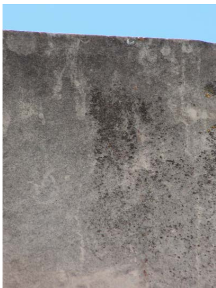
Fig. 44. Ejemplo de depósitos originados por las aves. (Fotografía de autor)
