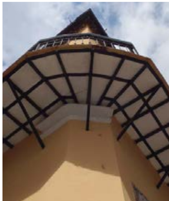
Fig. 3.34 Estructura de hierro del balcón del edificio entre Obrapia y Oficios. (PP)
