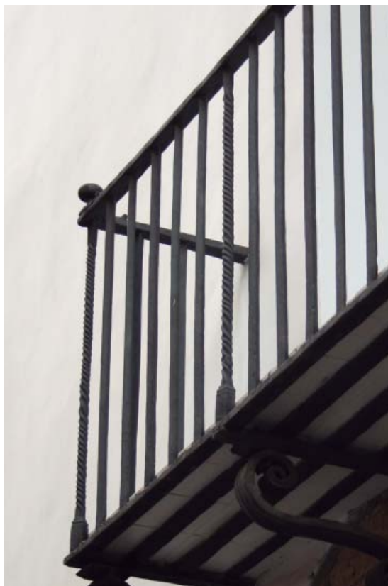
Fig. 8.39 Barrotes entorchados. Edificio Cat. MA-75. (PP)
