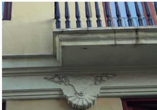
Fig. 8.89 Ménsula faltante y no reintegrada. Edificio cat. ME-17.
