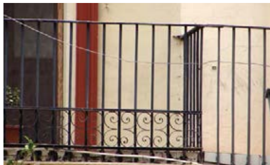
Fig. 6.33 Detalle balcón con decoración añadida.
