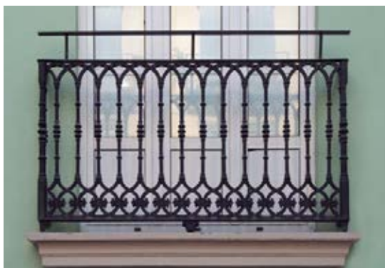
Fig. 9.46 Balcón reducido edificio n.3 Plaza San Bult. (PP)
