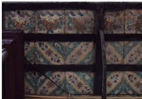
Fig. 7.5 Sotabalcón del edificio catalogado XE -68. (PP)
