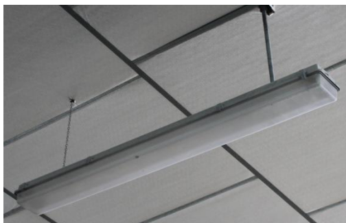
Figura 28. Luminarias de la zona de trabajo
