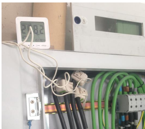
Figura 14. Contador instantáneo de electricidad instalado en el cuadro secundario
