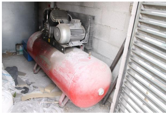
Figura 7. Compresor y depósito de aire
