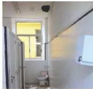
Aspecto de uno de los baños del colegio público donde el techo presenta daños.
