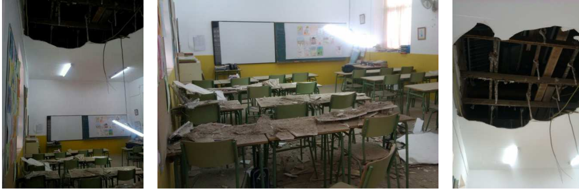
Figura 4. Imágenes del derrumbe del falso techo. Fuente: Begoña Serrano Lanzarote.
