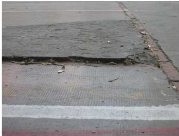
Figura 45. Pavimento deteriorado. Fuente: Begoña Serrano Lanzarote.
