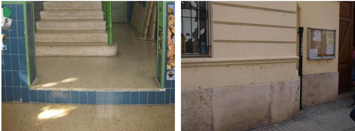
Figura 35. Peldaños que no cumplen requisitos. Fuente propia.
