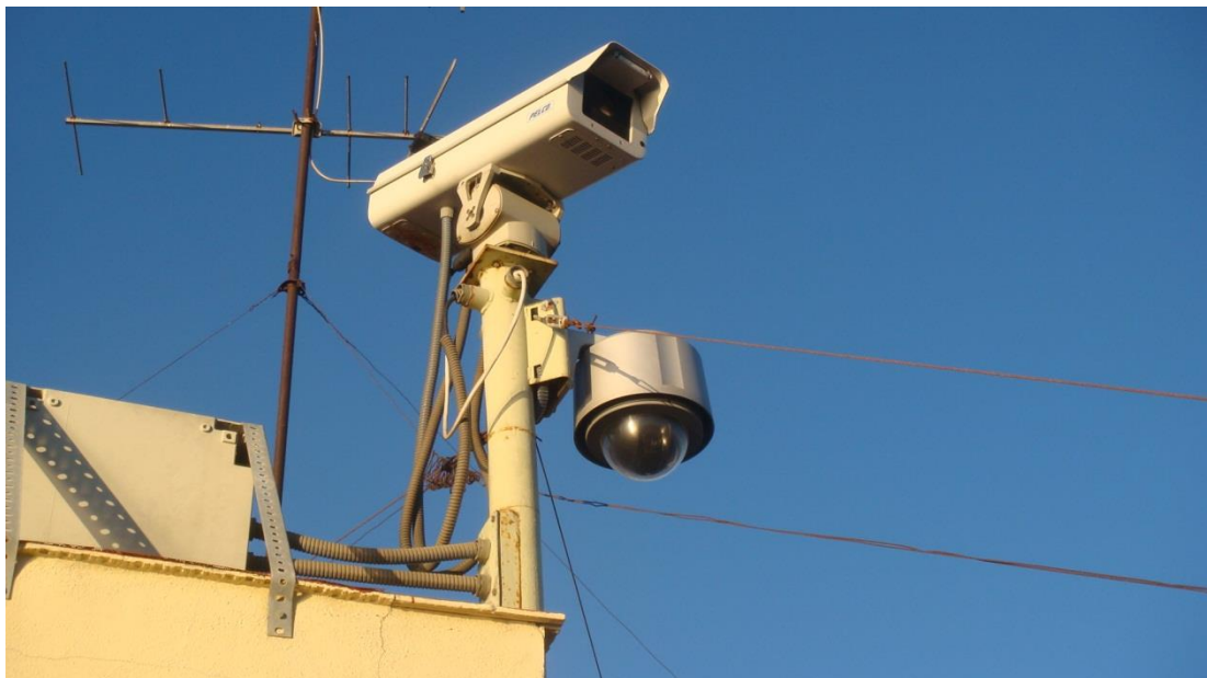
Figura 31: Cámara térmicas móvil y cámara de vídeo ubicadas en el edificio Gola nº 26
