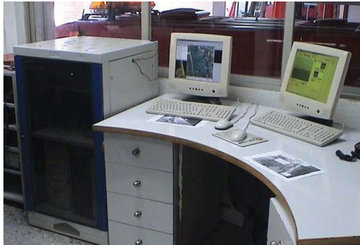
Figura 37: Unidades de gestión y monitorización de alarmas situada en el Centro de Comunicaciones del Parque Central de Bomberos
