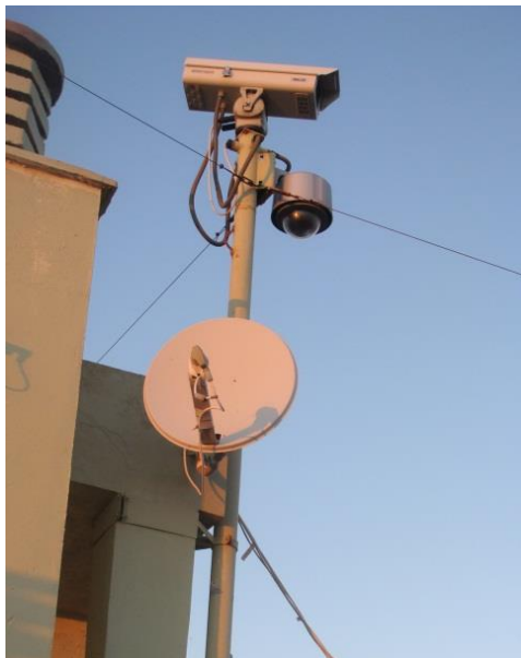
Figura 33: Cámara térmica móvil y de vídeo del Edificio Gola 10
