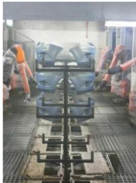
Fig. 2.16 Cabina de pintura
