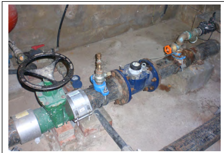
Tubería de entrada al depósito de Benirredrá (Red en Alta de La Safor)
