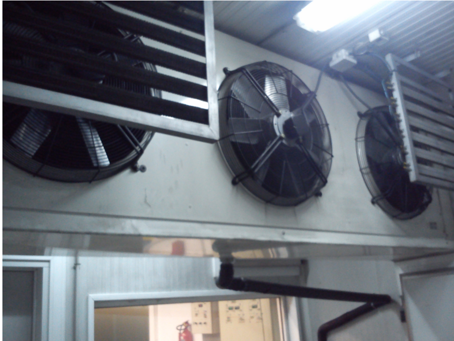
Figura 3: Ventiladores de refrigeración
