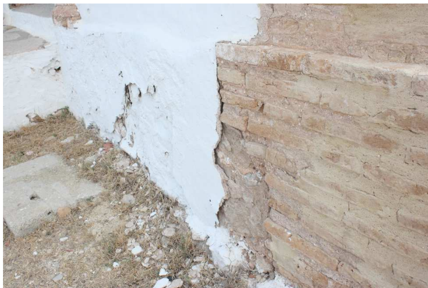
Figura 62 Capa de enfoscado de mortero de cal y las distintas capas de pintura acumuladas con los años sobre la mampostería.
