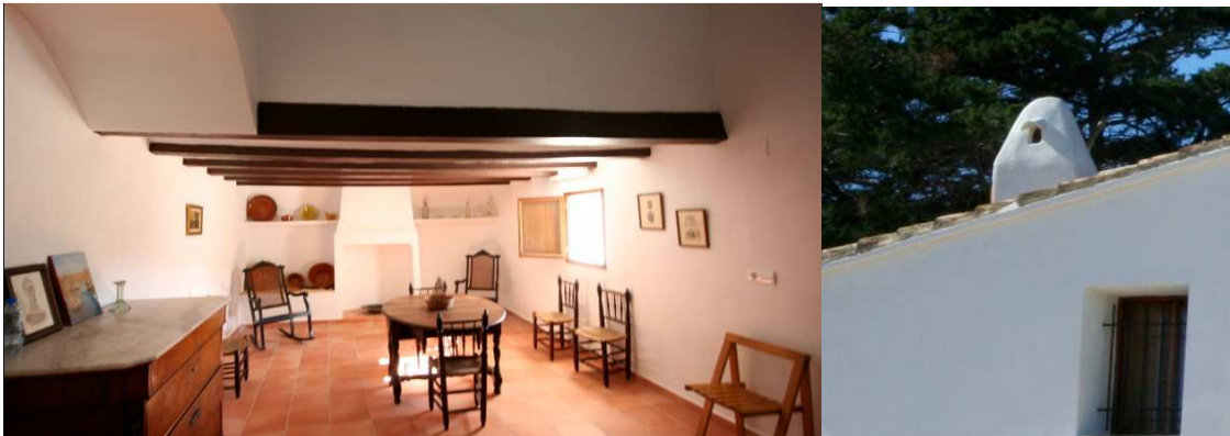
Figura 73 Chimenea en la cocina de la vivienda del ermitaño y chimenea en la parte exterior, fachada este
