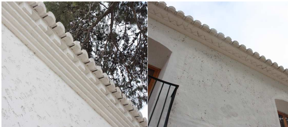
Figura 89 Alero muro norte Ermita dels Sants de la Pedra Sueca (vigas de cubierta vistas) y alero muro sur Ermita dels Sants de la Pedra de Sueca
