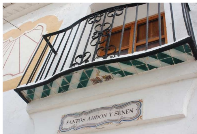
Figura 42 Detalle de la forja de la baranda del balcón de la década de 1960
