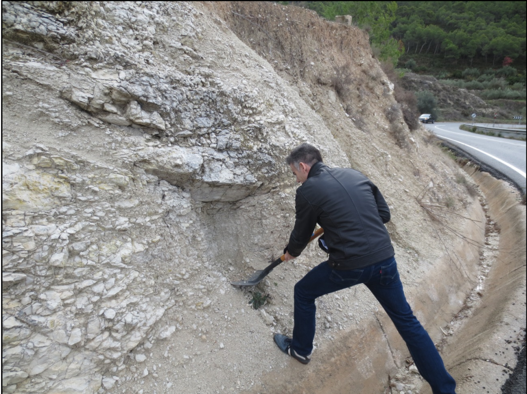
Figura 5.2.33. Ligeros desprendimientos del talud debidos a la meterorización del material margoso.
