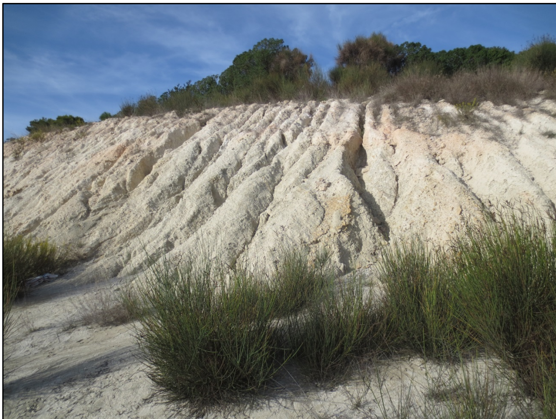
Figura 4.3.12. Aspecto del desmonte existente previa ejecución de la obra. García y Cuadrado, 2010.
