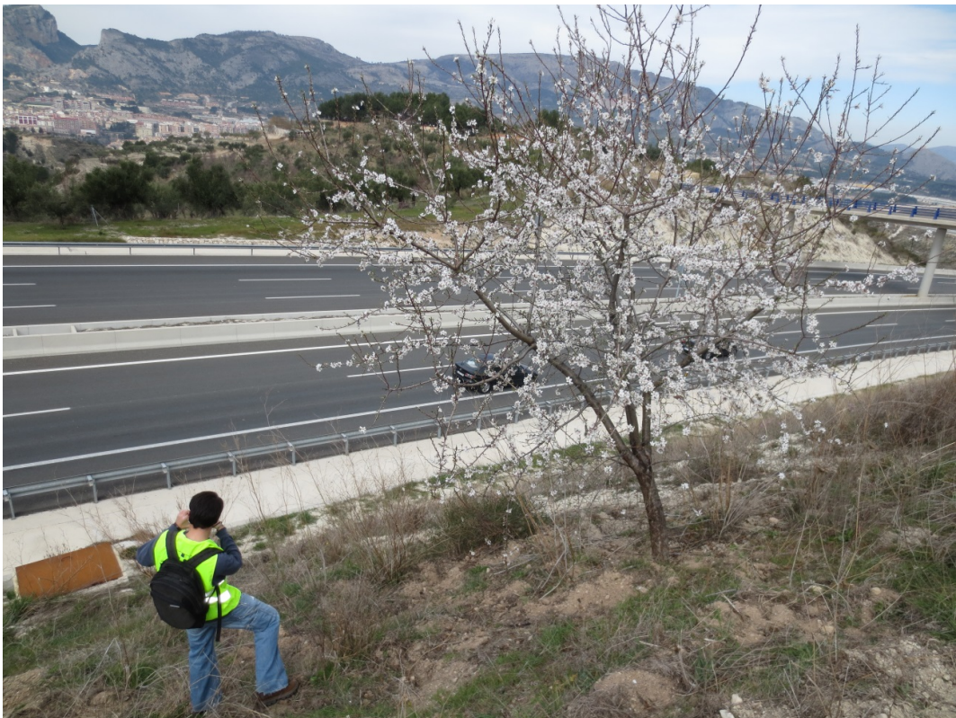
Figura 5.2.23. Vegetación y árbol sobre el talud. DIT14-201.
