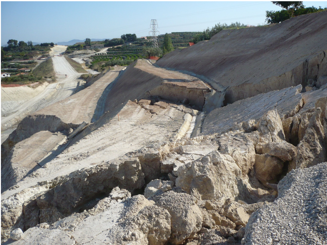
Figura 8.3.7. Vista superior de un deslizamiento rotacional ocurrido en los desmontes en Facies Tap durante las obras de construcción de la Variante de Alcoy.
