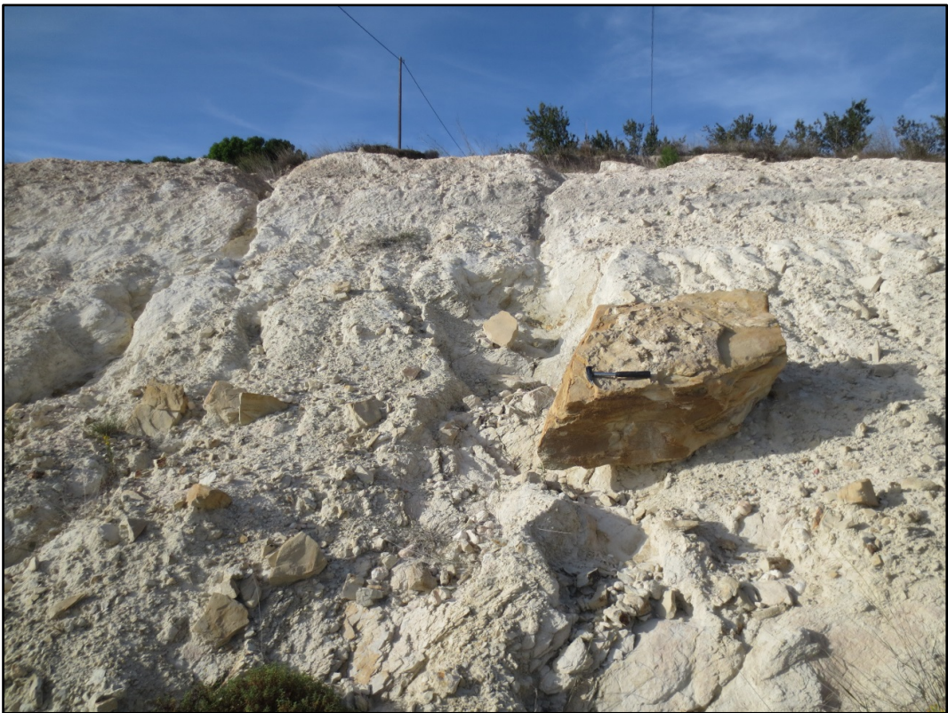
Figura 5.2.44. Gran bloque encontrado sobre el talud.
