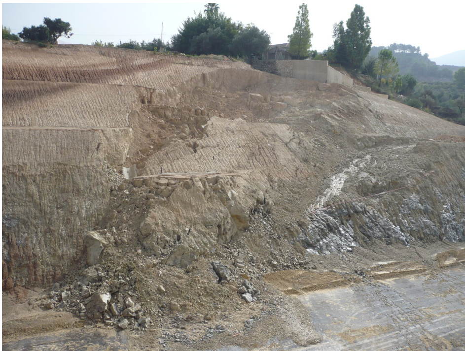
Figura 1.3. Deslizamiento rotacional ocurrido en un desmonte ejecutado en materiales de las Facies Tap.
