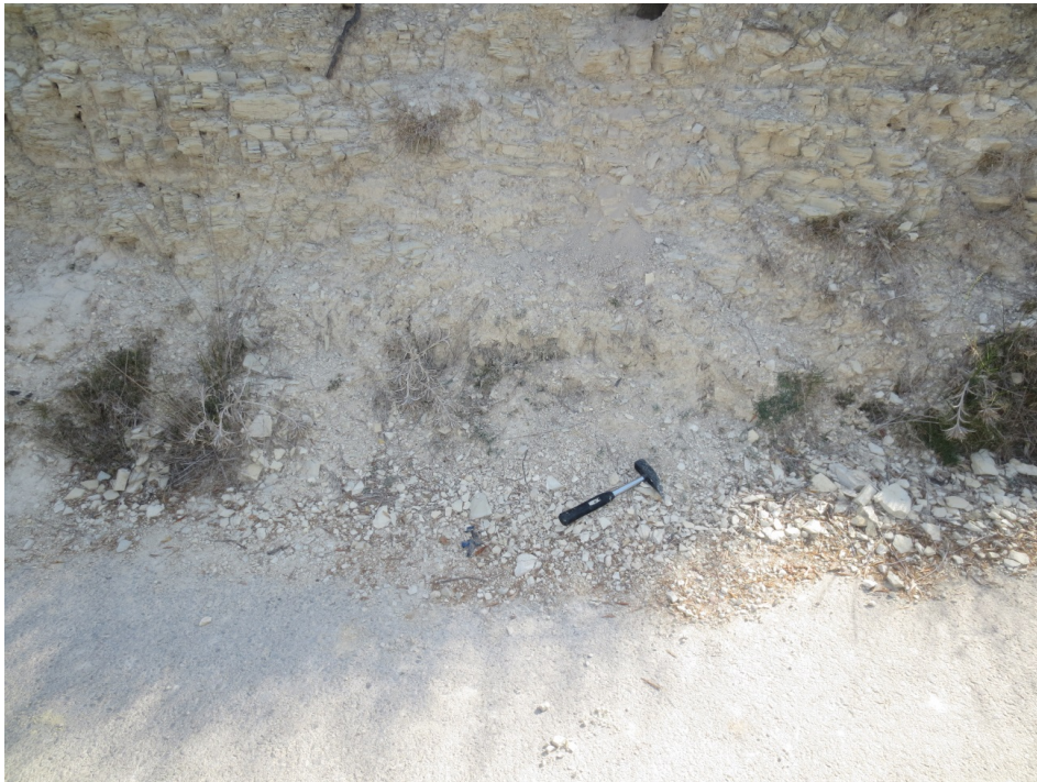
Figura 1.2. Caídas de cantos y bloques al pie de un desmonte ejecutado en materiales de las Facies Tap.
