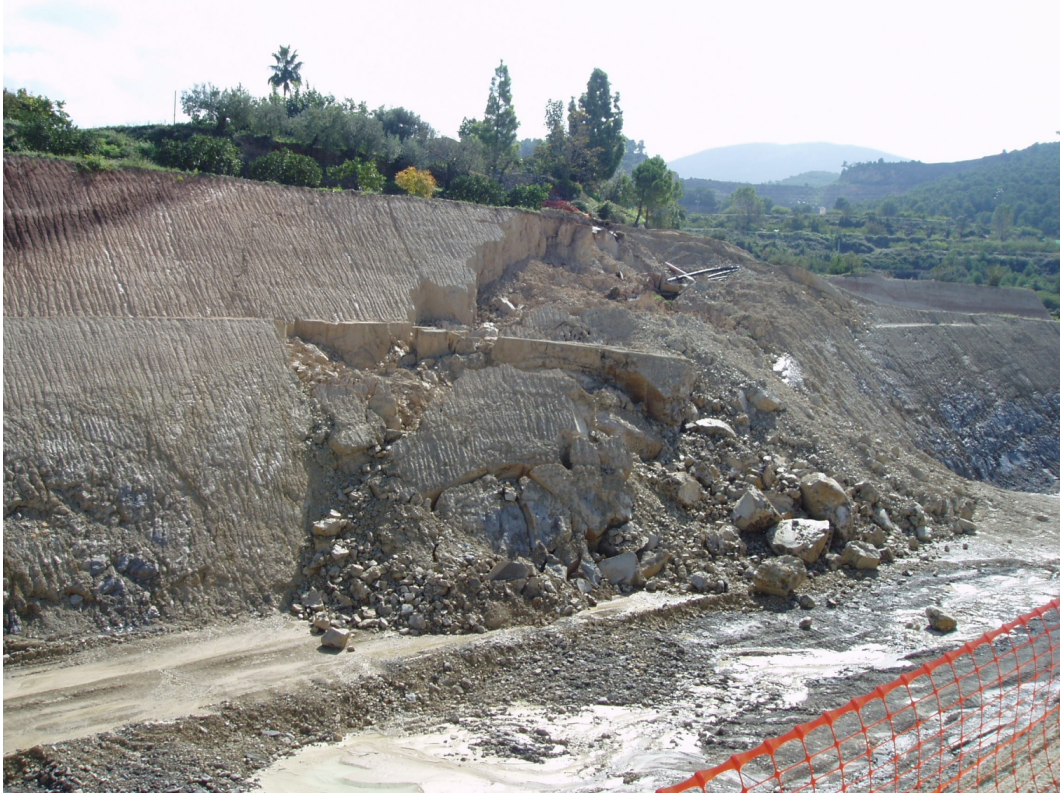
Figura 8.3.6. Vista frontal de un deslizamiento rotacional ocurrido en los desmontes en Facies Tap durante las obras de construcción de la Variante de Alcoy.
