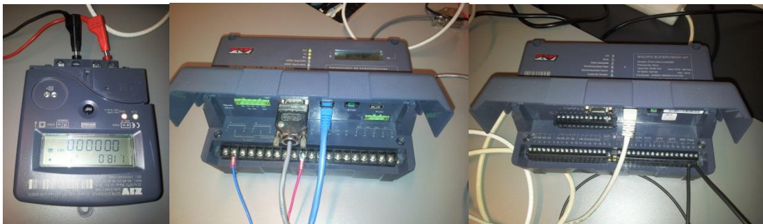
Figura 94. Smart meter, CTT y CAT
