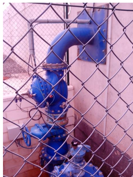
Figura 3-26. Válvula neumática de entrada al depósito
