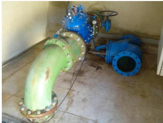
Figura 3-15. Válvula hidráulica de entrada a Depósito Cota 55
