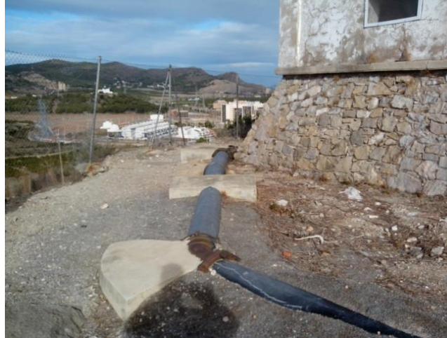
Figura 3-13. Tubería de conexión no operativa entre Depósitos Cota 110 y Cota 55
