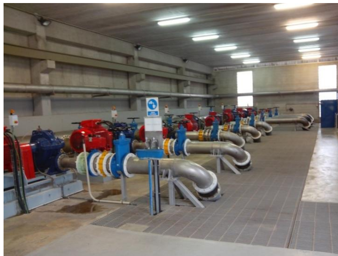
Figura 3-6. Estación de bombeo con los 3 grupos de bombeo
