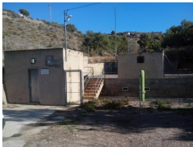
Figura 3-16. Caseta de maniobra, tubería de llenado y Depósito Cota 55
