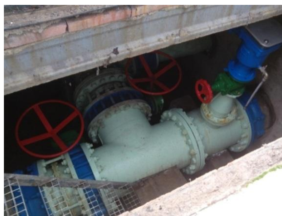
Figura 3-18. Vista del arquetón: Salida \varnothing 500 y entronque de la tubería \varnothing 600
