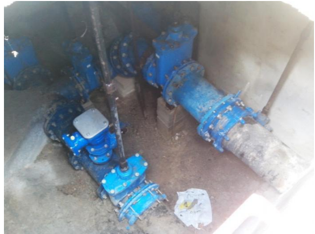
Figura 3-10. Arquetón en el que se encuentra la bifurcación hacia Sagunto Centro Urbano y Norte Palancia
