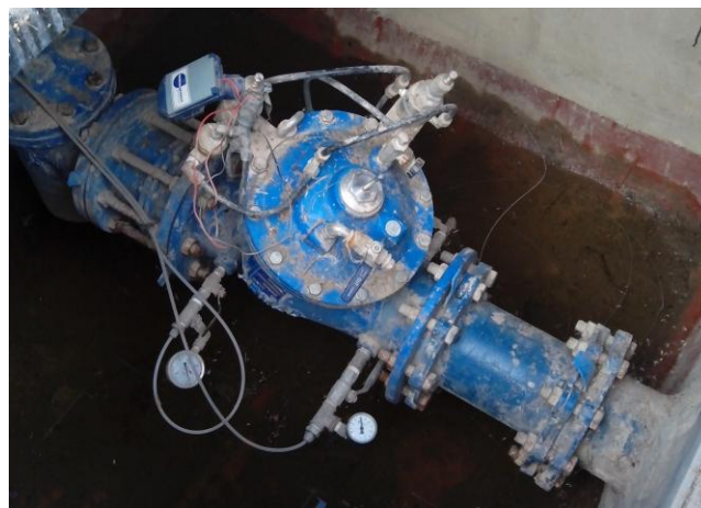
Figura 3-28. Válvula Reductora de Presión a la entrada de L'Almardà
