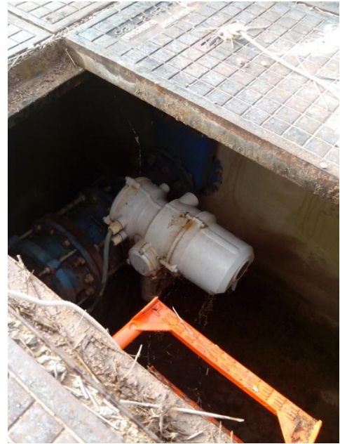
Figura 3-20. Electrovalvula que regula la entrada al depósito
