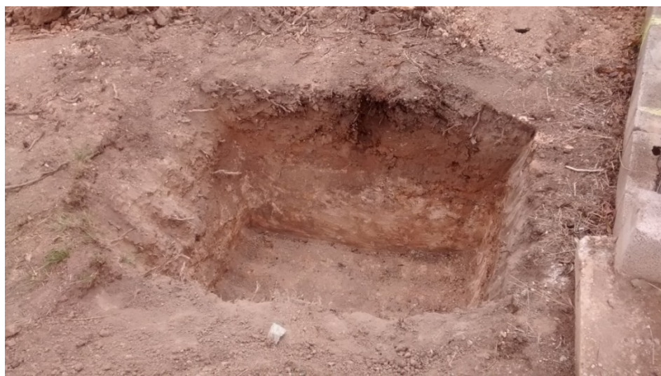
Figura 69. Excavación realizada para la eliminación de raíces de una palmera. A la derecha se observa los ladrillos de hormigón que sustentan la valla de protección de la torre.
