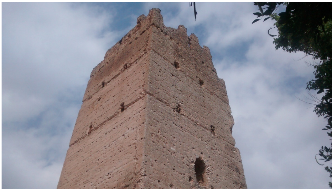
Figura 32. Imagen tomada el día de reconocimiento, en la que se aprecian los daños de la torre.
