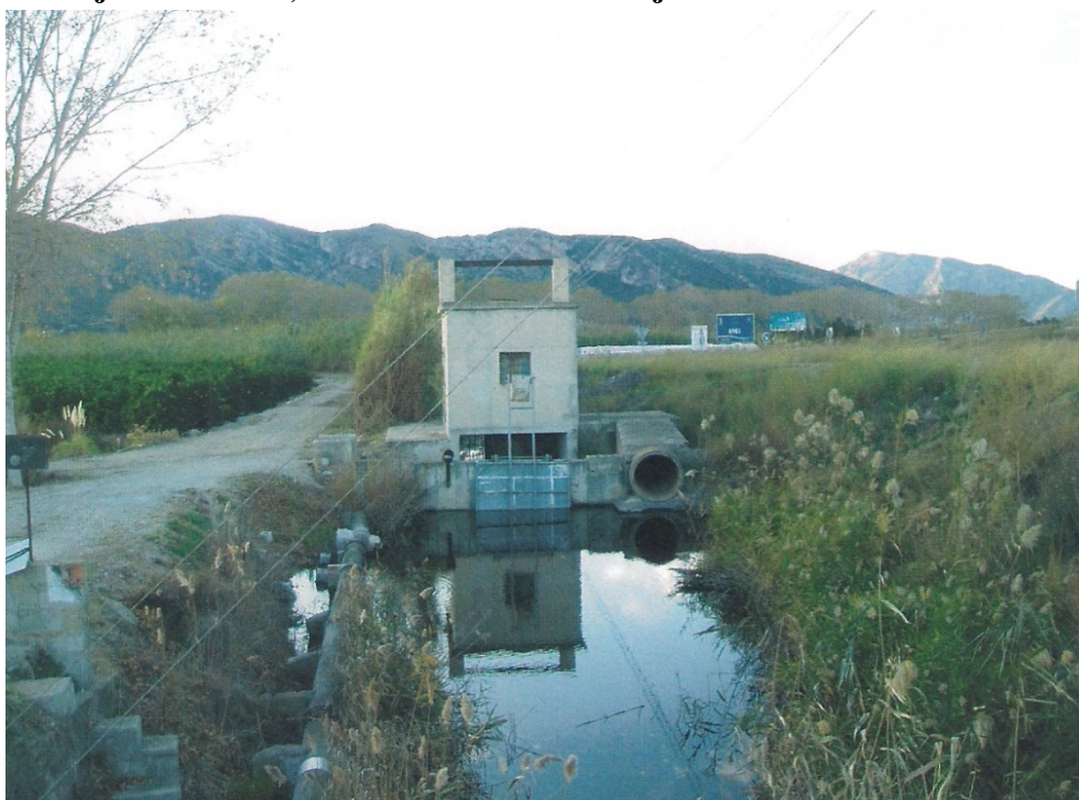
6-Compuerta automática de desagüe al río Jaraco
