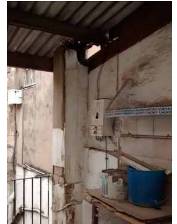
Figura 087. Detalls de pilars en mal estat. Pròpia autora.
