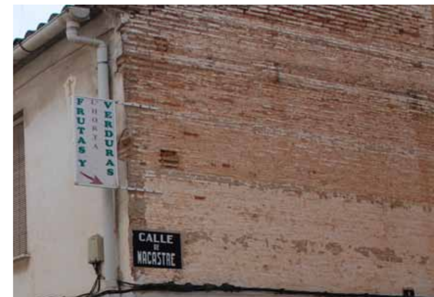
Figura 088. Detall d'erosió en façana. Pròpia autora.
