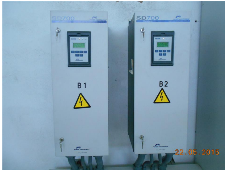
Fig. 10. Variadores de velocidad para control de motores.
