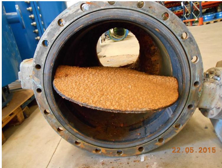
Fig. 12. Estado de una válvula de mariposa usada.
