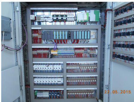
Figura 41. Cuadro eléctrico de control de una estación remota.
