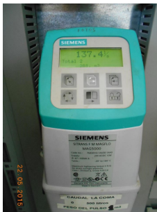
Figura 32. Electrónica de caudalímetro electromagnético. Fuente: elaboración propia, 2015
