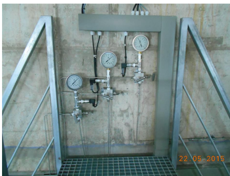
Figura 30. Manómetros depresión. Fuente: elaboración propia, 2015
