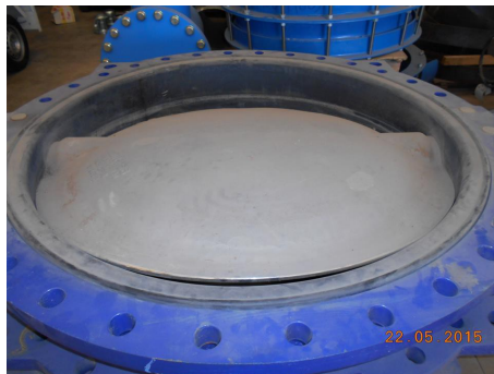
Figura 35. Válvula de mariposa. Fuente: elaboración propia, 2015
