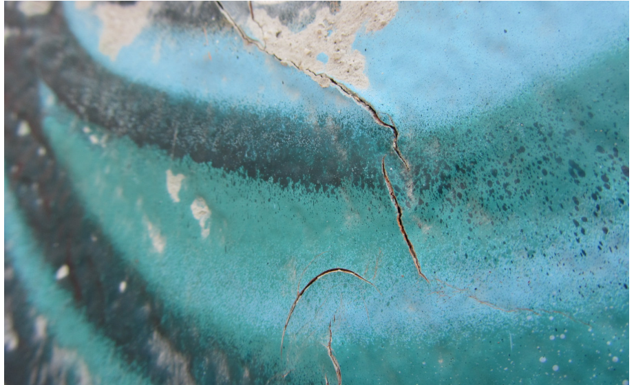
Figura 40. Detalle de grietas y abolsamiento.
