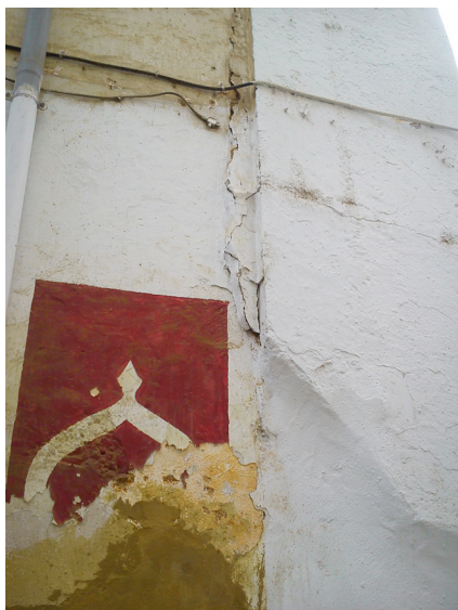
Figura 23. Grietas estructurales, fachada del edificio.
