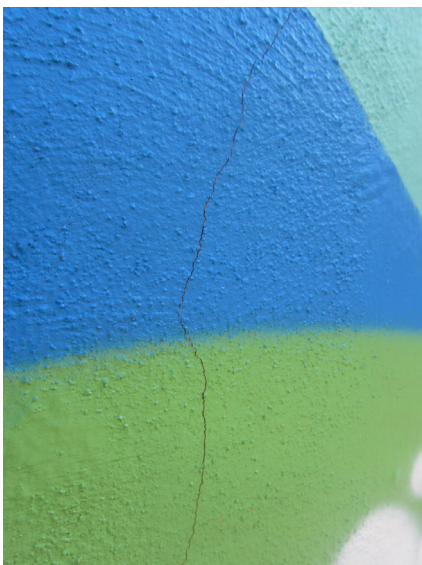
Figura 36. Detalle grieta de carga en altura.
