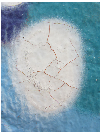
Figura 25. Detalle grietas de secado.
