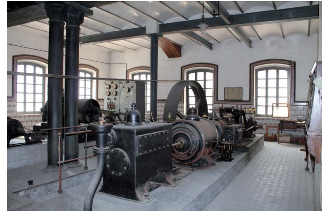
sala de máquinas. motor hidráulico
