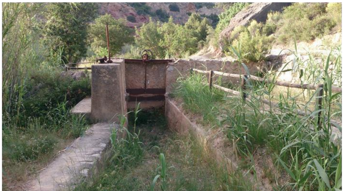
Figura 8: Toma de agua en la actualidad. Fuente: Propia.
