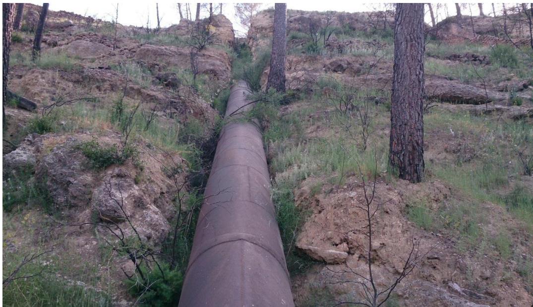
Figura 6: Tubería forzada que iba del depósito de cargas a la turbina. Fuente: Propia.
