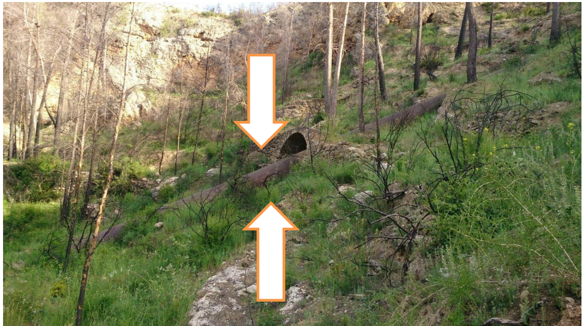
Figura 12: Tubería forzada empleada en su época vista desde un lateral. Fuente: Propia.
