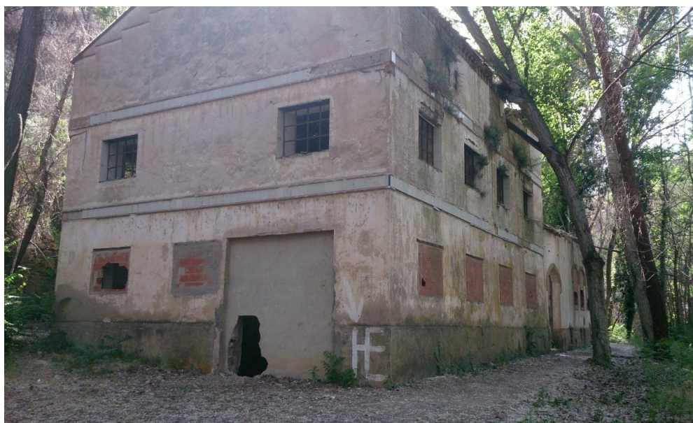
Figura 5: Edificio de la central que contenía una turbina Francis horizontal. Fuente: Propia.
