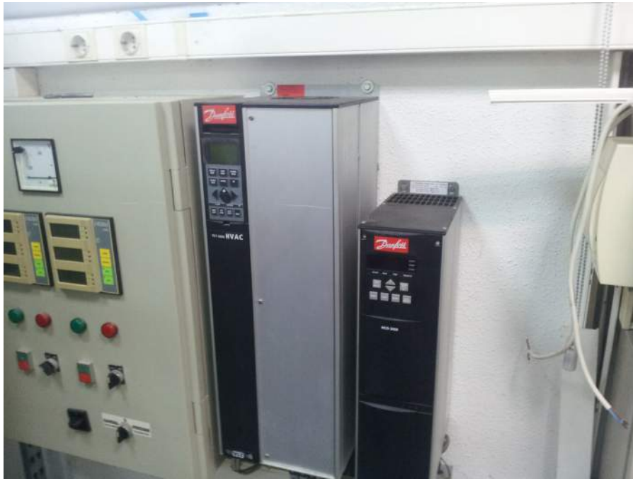
Figura 37. Variador de frecuencia.
