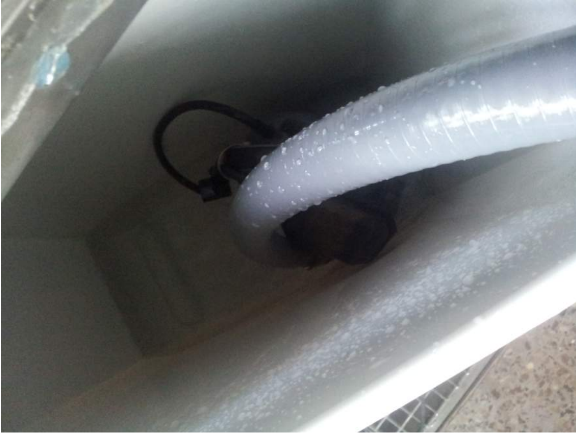
Figura 24. Depósito de 60l con bomba de achique.
