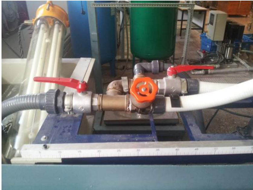
Figura 22. Válvulas de compuerta (naranja) y válvulas de esfera (rojas).
