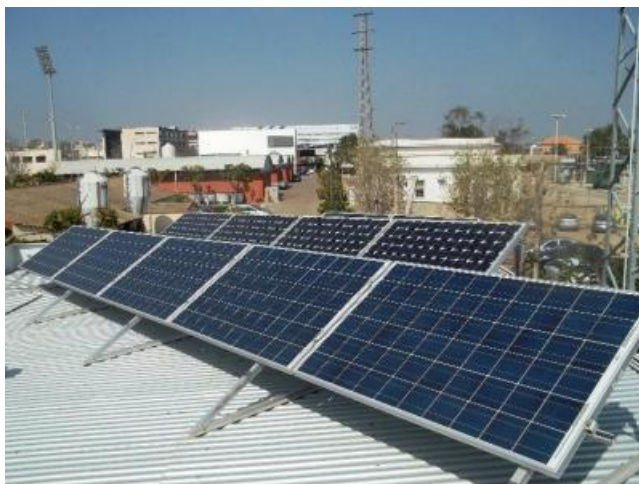
Figura 7.1.1: Sistema fotovoltaico del LabDER, UPV
