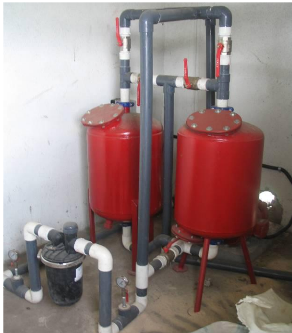
Figura 3.5 Cabezal de bombeo del sistema de riego por gradiente – caseta de bombeo.
