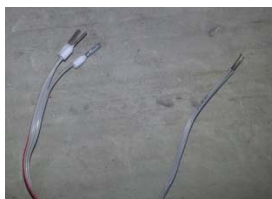
fig. 79 Cables con punteras.
