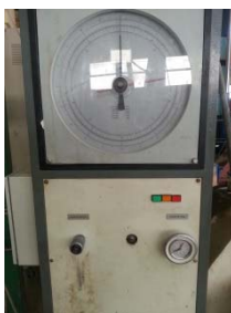
fig. 78 Mandos y control del grupo hidráulico
