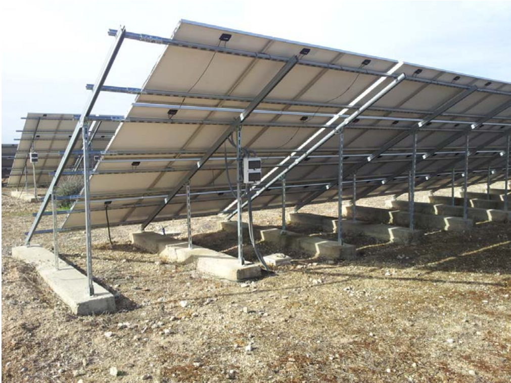
Fotografía 1. Ramal de 4 paneles. Parte trasera.
