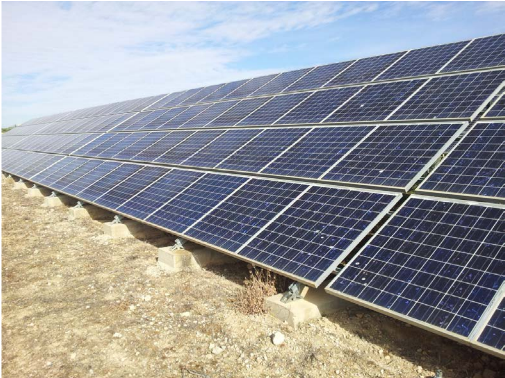
Fotografía 2. Ramal 4 paneles. Parte frontal.
