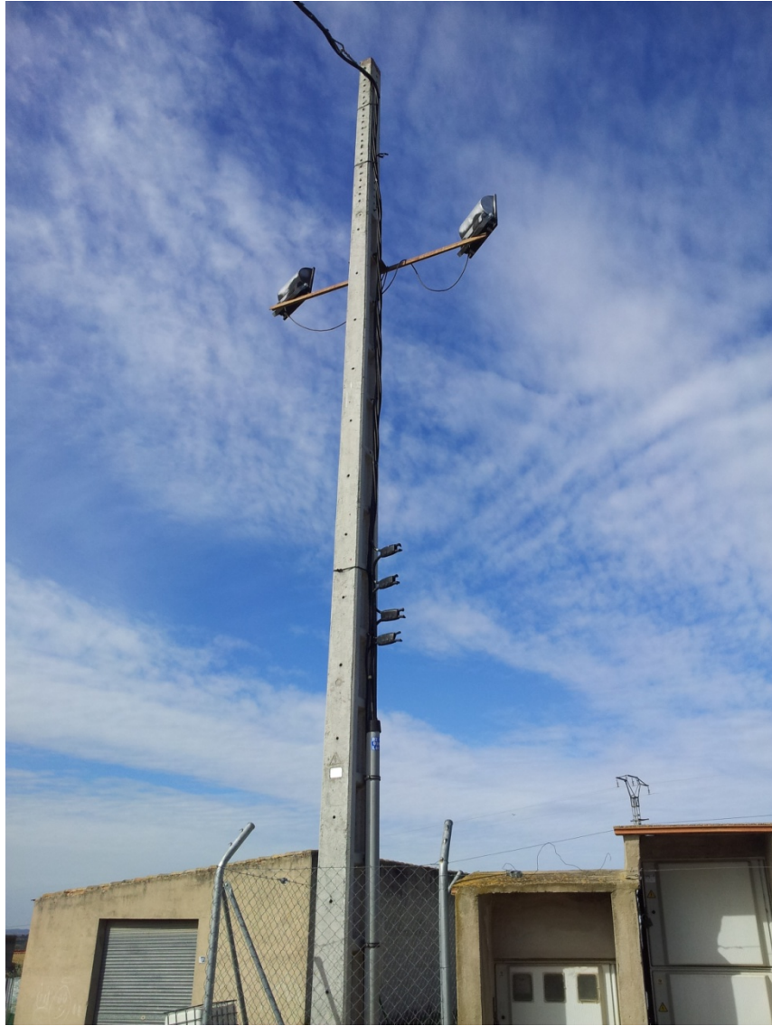
Fotografía 6. Poste de conexión a la red pública.
