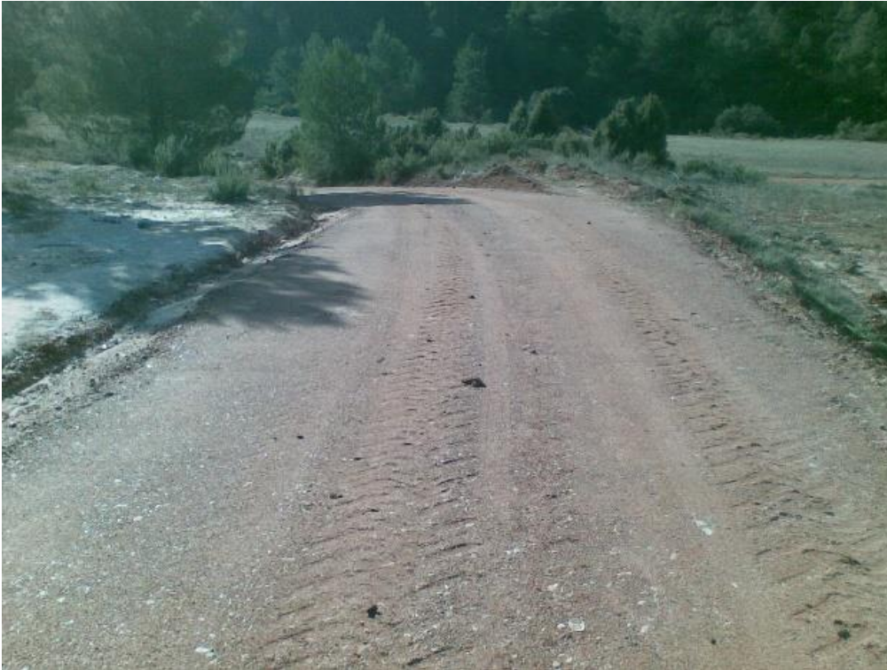
Foto 14. Zahorras saturadas. Se aprecian roderas. Fuente: Propia 1
