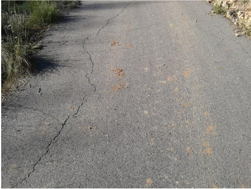
Foto 60. Ligeras grietas puntuales del asfalto. Fuente: Propia
