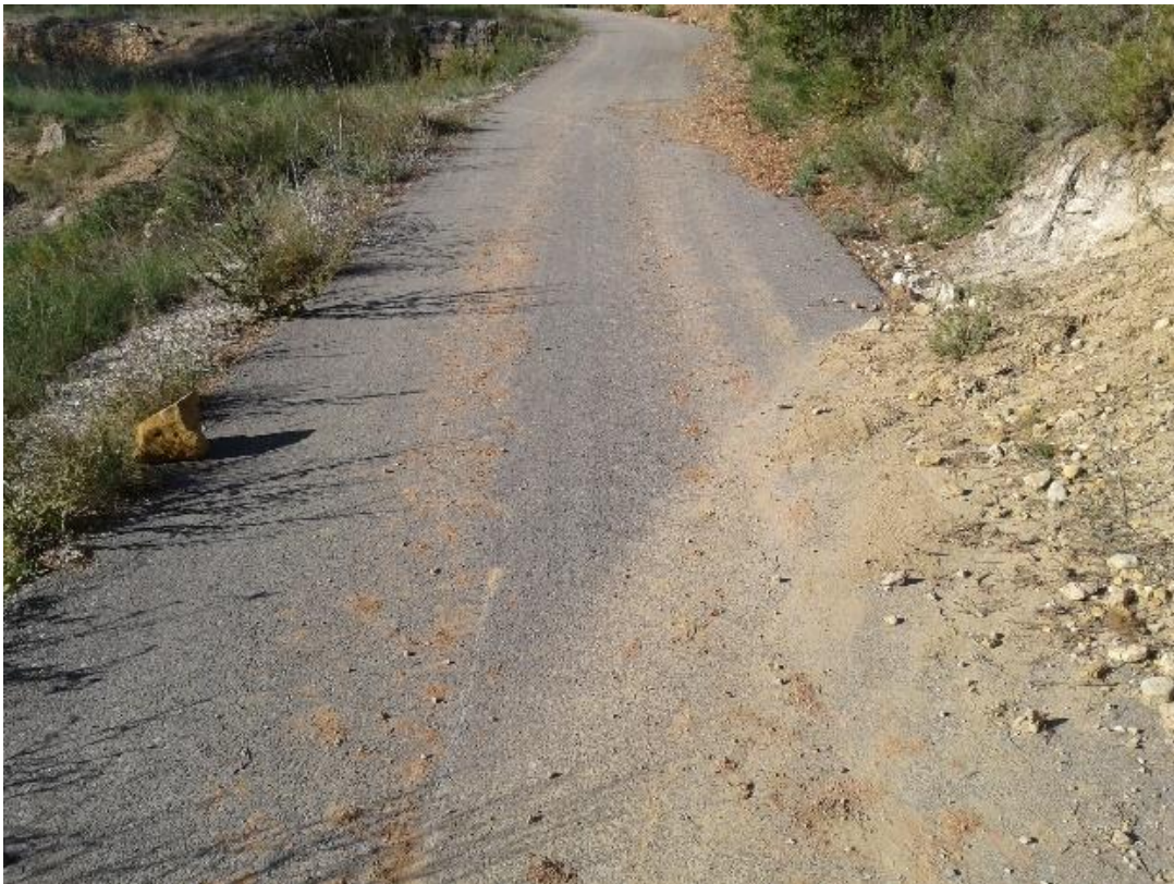
Foto 59. Tierras y gravas de escorrentía invaden el pavimento. Fuente: Propia.
