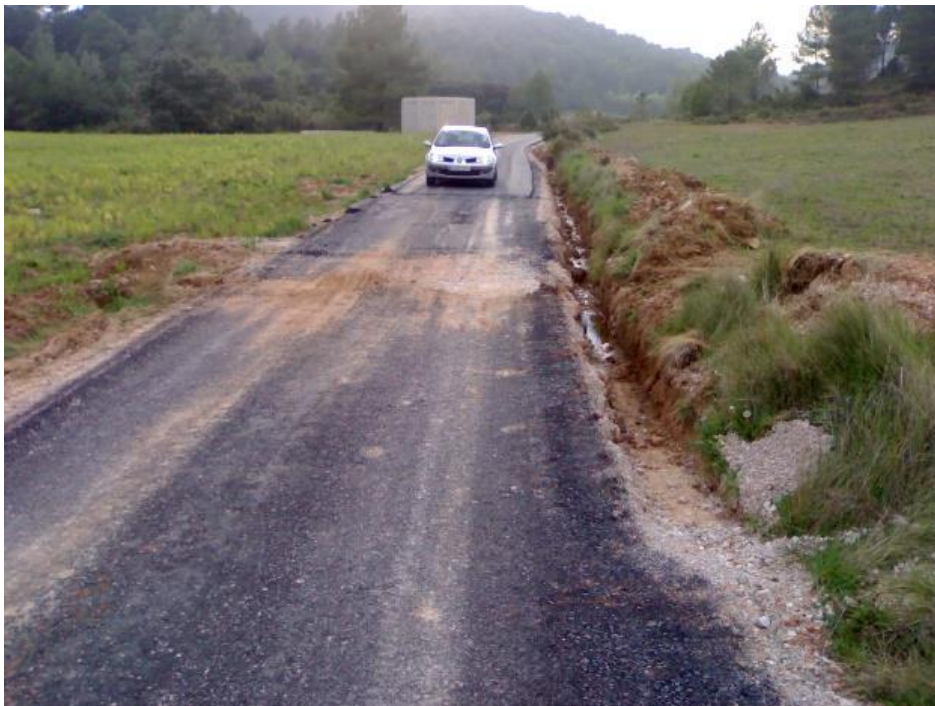
Foto 41. Continúa mojado. Fuente: Propia.
