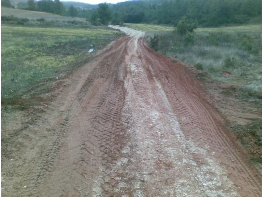
Foto 46. Zahorras saturadas de agua. Fuente: Propia.
