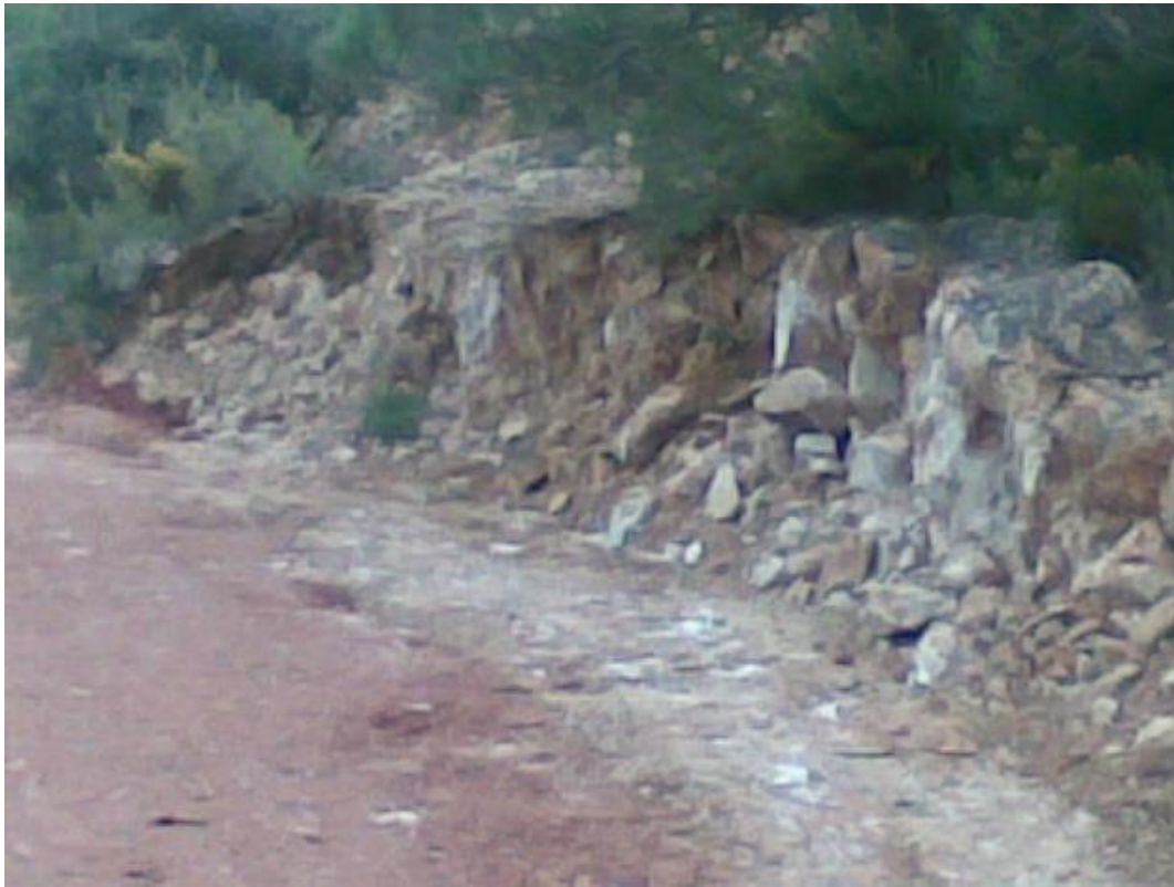
Foto 2. Picado de roca con el martillo de la retroexcavadora para cajar la sección tipo. Fuente propia
