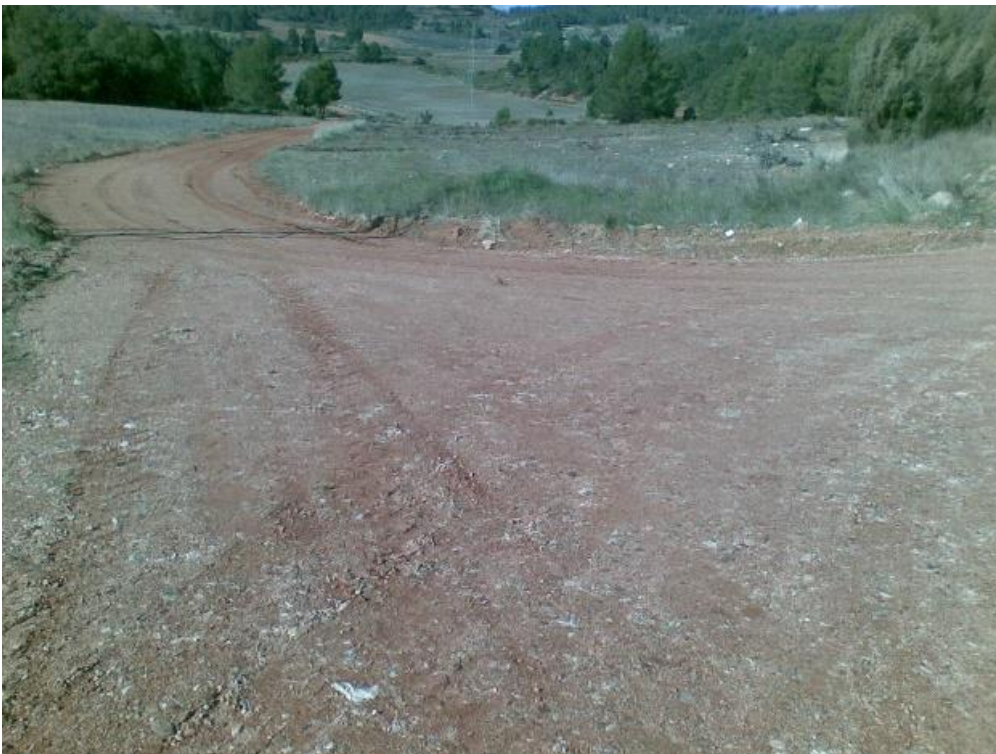
Foto 15. Zahorras saturadas. Se aprecian roderas. Fuente: Propia 2
