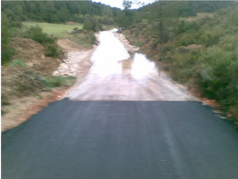
Foto 40. Baden inundado. Interrupción por lluvias del Asfaltado. Fuente: Propia.
