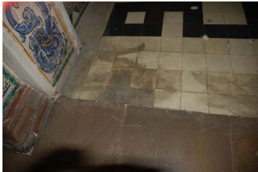
Figura 60. Humedades en el suelo.
