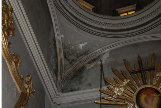
Figura 59. Humedades pechinas capillas laterales.
