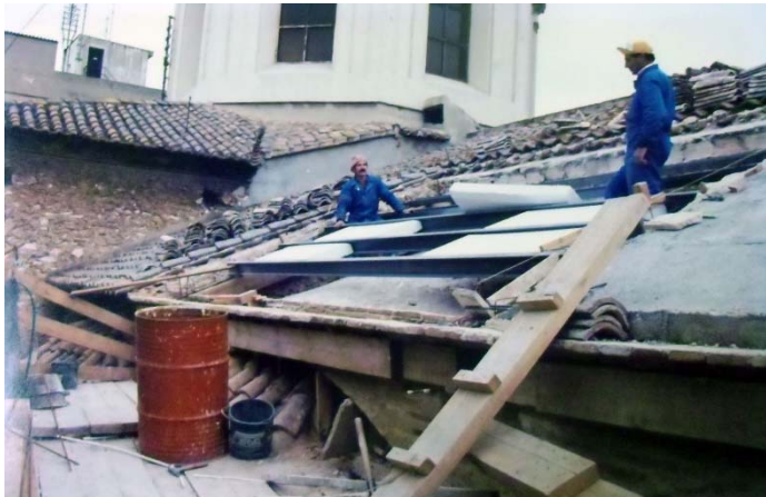
Figura 34. Fotografía de la zona reparada de la cubierta encontrada en el Archivo Parroquial de la Iglesia de San miguel y San Sebastián.
