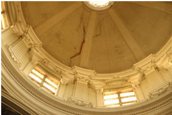
Figura 56. Grieta cúpula principal.
