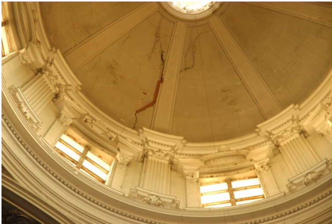
Figura 41. Fotografía de la grieta de la cúpula principal.
