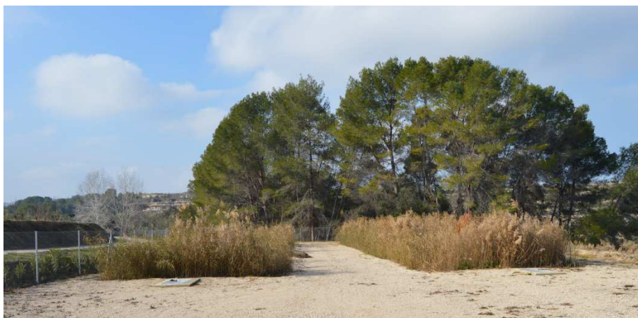
Ilustración 12. Humedales artificiales subsuperficiales de flujo horizontal.
