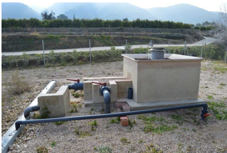
Ilustración 14. Arqueta 1: Arqueta de reparto del agua residual a las dos celdas de flujo horizontal
