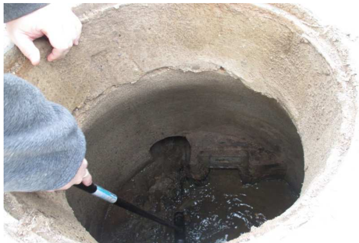
Ilustración 39. Colector de entrada al humedal obturado. (Foto tomada el 07/04/2015)
