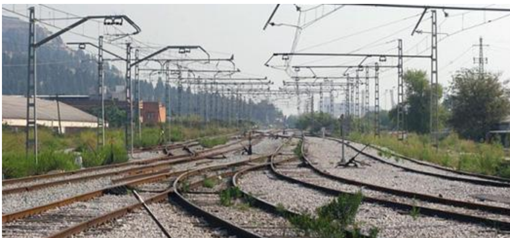
Imagen 7.14: Electrificación ferroviaria. Fuente: http://www.adif.es
