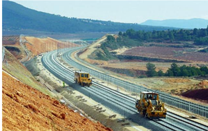
Imagen 7.13: Trabajos de montaje de vía en la línea de alta velocidad Madrid-Valencia a su paso por Requena. Fuente: http://www.google.com
