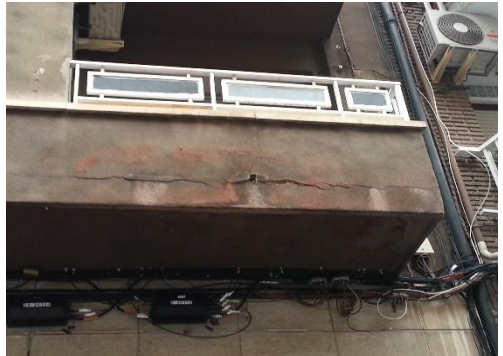
Ilustración 53 Oxidación pieza desagüe provocando una fisura. Fuente Luis Navarro
