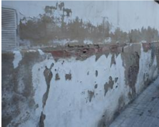
Ilustración 38. Humedad por capilaridad. Fuente propia. Edificio de estudio Marzo 2015
