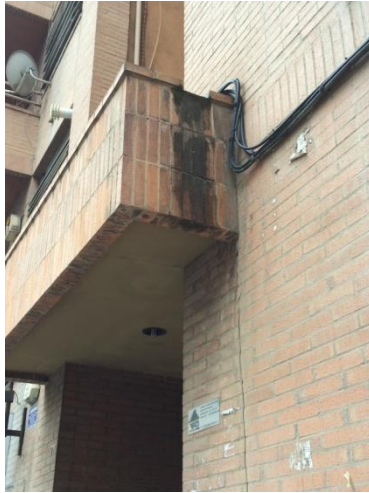
Ilustración 39. Humedad accidental. Fuente propia. Abril 2015
