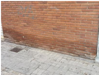
Ilustración 57 Erosión parte baja de ladrillo caravista. Fuente propia Abril 2015
