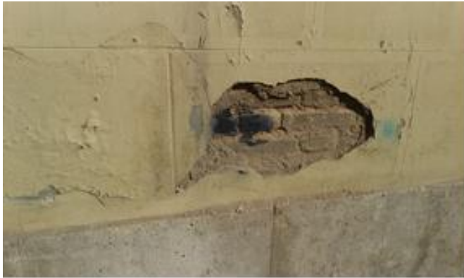
Ilustración 49. Desprendimiento acabado continuo. Fuente Luis Navarro.
