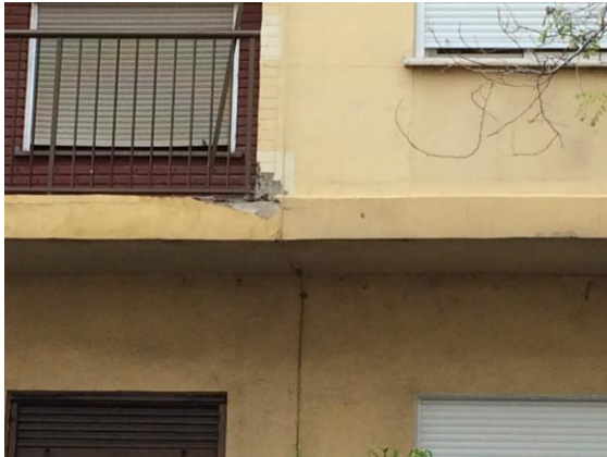
Ilustración 35. Ejemplo de anclaje como elemento impropio en edificio de estudio. Abril 2015.
