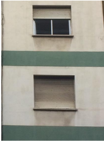
Ilustración 41. Ensuciamiento por deposición. Fuente propia. Abril 2015
