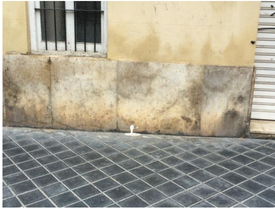
Ilustración 38. Humedad por capilaridad. Fuente propia.
