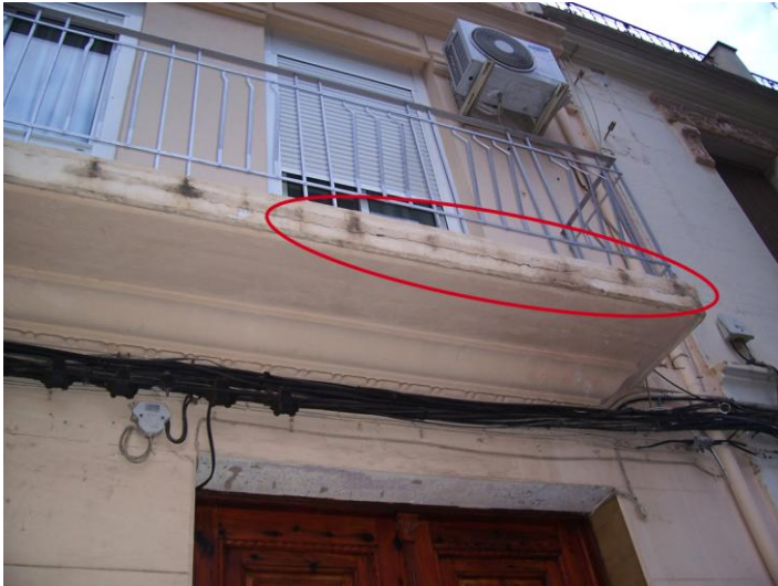
Ilustración 48 . Fisura en balcón. Fuente Guillem Aparici.
