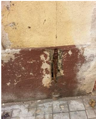
Ilustración 52 Oxidación de la consiguiente rotura del revestimiento. Fuente Luis Navarro
