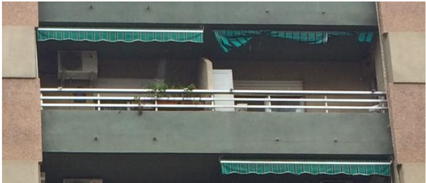
Ilustración 33. Balcón revestido con un punto de desagüe en edificio de estudio.
