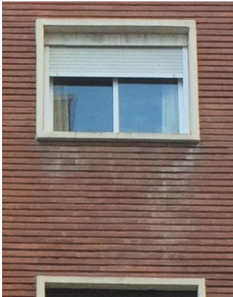
Ilustración 51 eflorescencia en entrada al patio de la finca. Fuente propia Junio 2015
