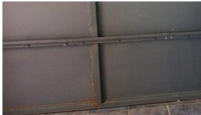
Ilustración 54 Corrosión por aireación diferencial. Fuente de internet (google corrosión por aireación diferencial)-22/06/2015 19:33
