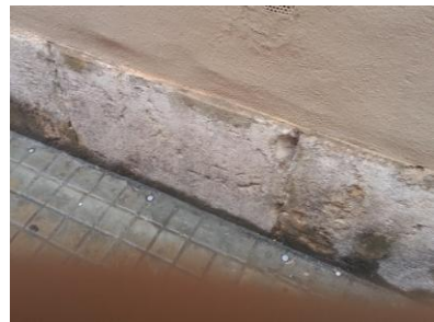
Ilustración 58 Erosión del zócalo del edificio. Fuente propia. Abril 2015
