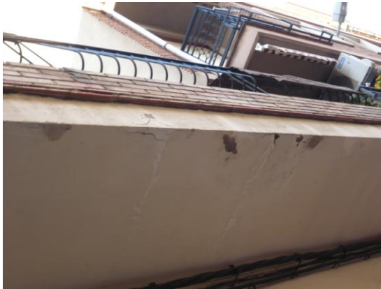
Ilustración 40. Humedad por filtración. Fuente propia. Abril 2015
