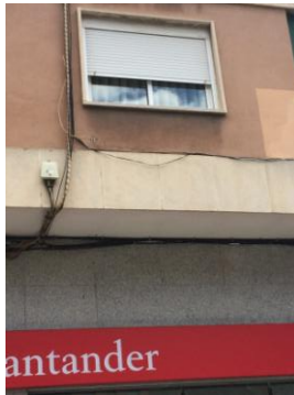
Ilustración 42. Ensuciamiento por deposición. Fuente propia. Abril 2015
