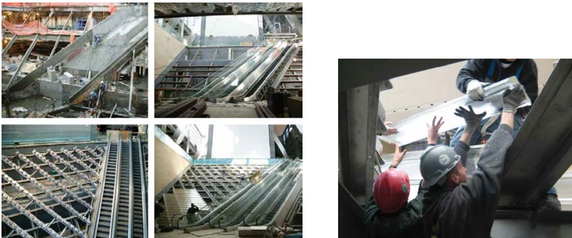
Figura 35: “Icefall”, diferentes fotos de la construcción de la cascada del acceso principal. Fuente: Ficeto, M. Hearst Icefall. Lobby Water feature Shines On.
