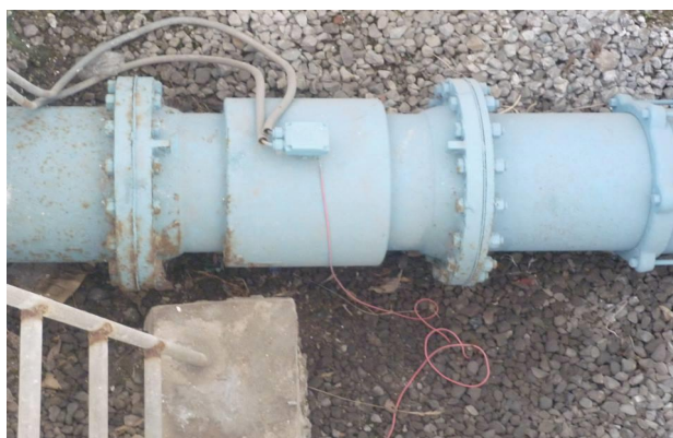
Figura 53 macromedidor instalado a la salida de la Planta de Caranqui.
