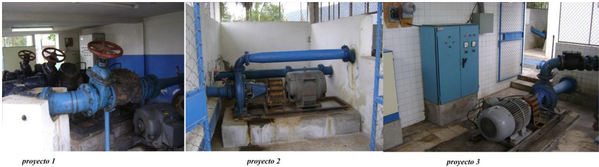
Figura 13 Estacion de bombeo en Yuyucocha.
