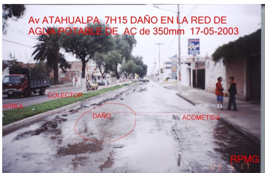
Figura 50 Daño en la Av Atahualpa provocado por las raíces de los árboles.
