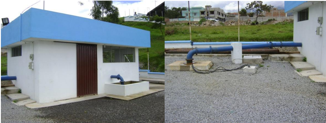
Figura 15 Estación de bombeo Caranqui.
