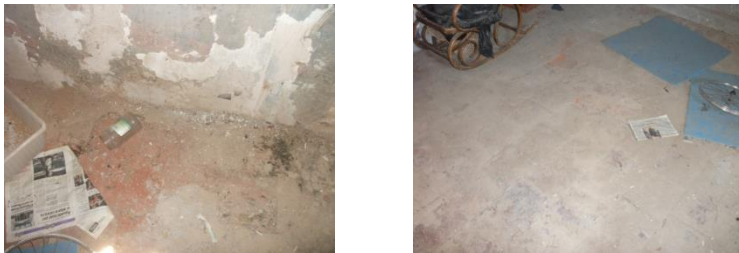
Figura 83. Suciedad y rotura del solado de la Sala de estar en planta 1ª. 2015. Fuente propia
