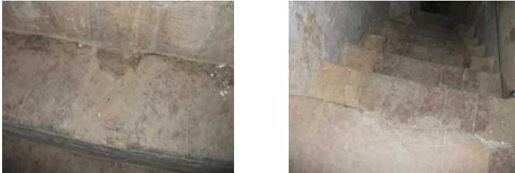
Figura 82. Falta de baldosa, desgaste y suciedad en el solado de las escaleras de comunicación con la planta 2ª. 2015. Fuente propia
