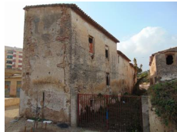
P.33 Ennegrecimiento y desprendimiento del enfoscado
