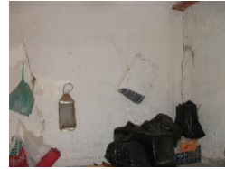
P.31 Grieta en esquina y centro de muro
