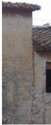
Figura 91. Grieta longitudinal en cambio de dirección de la fachada oeste. 2015. Fuente propia
