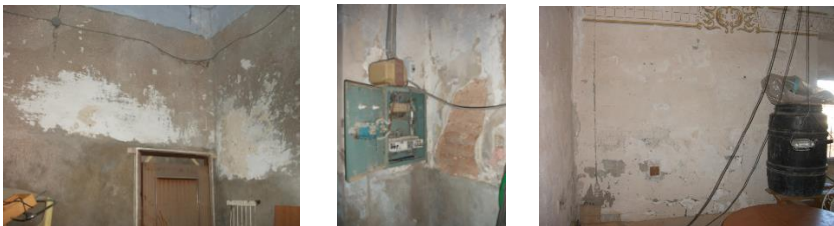
Figura 100. Desconchados y suciedad generalizada. 2015. Fuente propia
