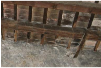
Figura 111. Rotura de piezas del tablero de rasillas en encuentro de muro. 2015. Fuente propia
