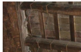
Falta de sección de par próximo a la cumbre
