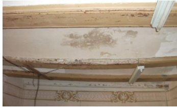
Figura 106. Deformación de vigueta de madera situada en planta 1ª. 2015. Fuente propia
