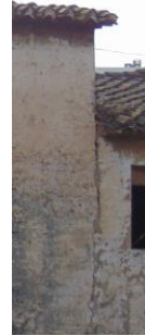
Grieta longitudinal en cambio de dirección de la fachada oeste
