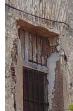
P.33 Desprendimiento del revestimiento debido al avanzado proceso de oxidación de la rejería
