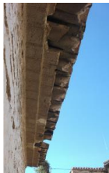
Figura 113. Rotura de piezas en cubierta de teja árabe. 2015. Fuente propia
