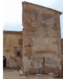
P.34 Pérdida del revestimiento de la fachada norte
