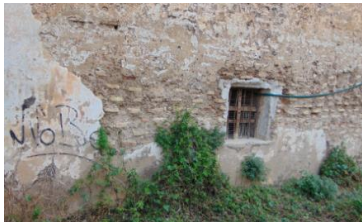
Figura 85. Pérdida del revestimiento de la fachada oeste (muro de tapia). 20015. Fuente propia
