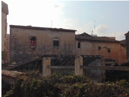
Figura 21. Vista de la fachada oeste de ambos volúmenes desde el brazal de Les Barraques. 2015. Fuente propia
