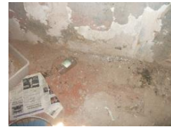
Rotura de piezas en planta 1ª
