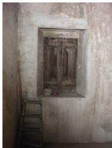
Figura 97. Manchas por filtración de agua bajo el alféizar de la ventana y mohos en esquina de planta 2ª. 2015. Fuente propia
