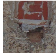
P.33 Pérdida de material en antepecho de ventana de la fachada oeste
