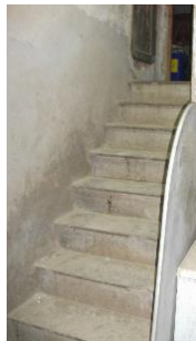
Figura 94. Manchas de humedad por capilaridad en revestimiento de mortero de cemento aplicado por el propietario en planta baja. 2015. Fuente propia
