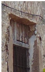
Figura 116. Desprendimiento del revestimiento debido al proceso de oxidación de la rejería metálica. 2015. Fuente propia
