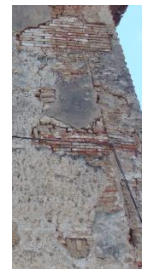
P.34 Grieta longitudinal en esquina de fachada norte del volumen 1
