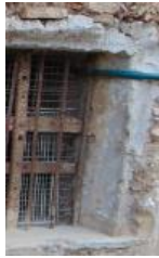
Figura 117. Manchas pardas en jamba de ventana situada en la fachada oeste. 2015. Fuente propia
