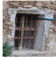
P.33 Manchas pardas en jamba de ventana
