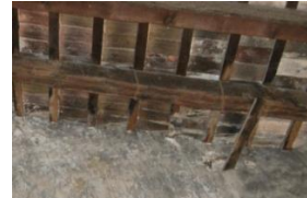
Rotura de piezas del tablero de rasillas en encuentro de muro
