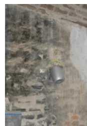
P.35 Ensuciamiento de paramento con hollín
