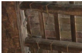
Figura 112. Pérdida de sección de par en la zona de la cumbreira. 2015. Fuente propia
