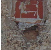
Figura 87. Pérdida de material en antepecho de ventana de la fachada oeste (tapia). 2015. Fuente propia
