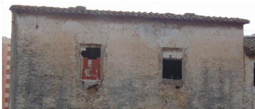
Figura 88. Ennegrecimiento de la fachada oeste. 2015. Fuente propia
