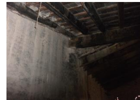
Manchas en paramentos y pudrición en vigetas
