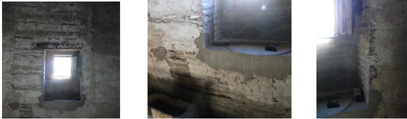
Figura 98. Cuarteado del revestimiento en las proximidades de ventana en planta 2ª. 2015. Fuente propia
