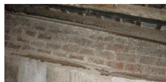
P.35 Mohos en la parte superior del muro
