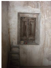
P.37 Manchas por filtración de agua bajo el alféizar de la ventana orientada a sur
