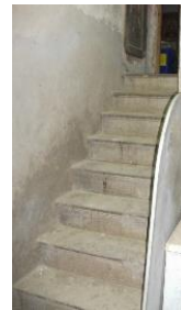
P.29 Manchas de humedad en revestimiento de mortero de cemento
