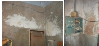
P.30 Pérdida del revestimiento por golpes con objetos
