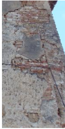
Figura 90. Grieta longitudinal en esquina de fachada norte del volumen 1. 2015. Fuente propia
