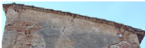
Figura 89. Fisuras inclinadas en el revestimiento debidas al empuje de la cubierta en la fachada norte del volumen 1. 2015. Fuente propia
