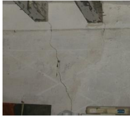
Figura 101. Fisura inclinada en paramento, bajo el apoyo de vigueta en planta 1ª. 2015. Fuente propia
