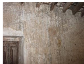
P.37 Manchas y cuarteado del revestimiento
