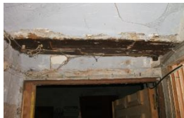
Figura 105. Fendas en cara inferior de vigueta de madera. 2015. Fuente propia
