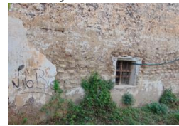
P.33 Pérdida del revestimiento de la fachada oeste (tapia)
