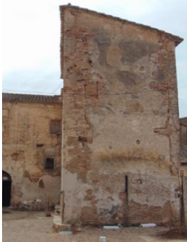
Figura 84. Pérdida generalizada del revestimiento. 2015. Fuente propia
