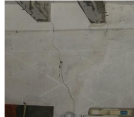
P.36 Fisura inclinada bajo apoyo de vigueta en planta 1ª
