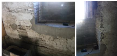
P.30 Cuarteado del revestimiento en ventana orientada a este
