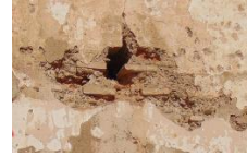
P.29 Pérdida de material en fachada
