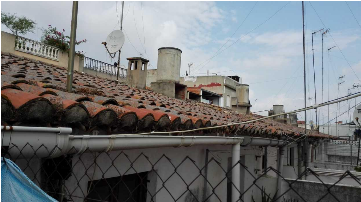
Ilustración 29. Gran cantidad de antenas y depósitos fibrocemento.
