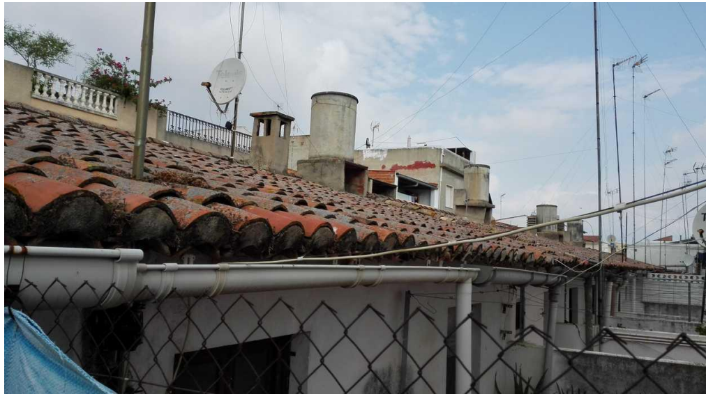
Ilustración 18. Depósitos Fibrocemento en cubiertas de garajes.
