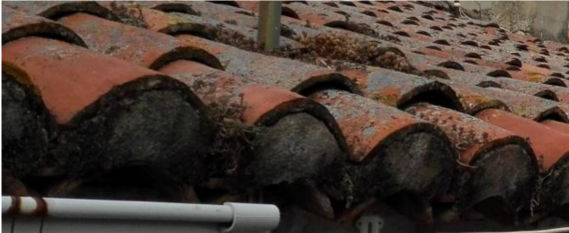
Ilustración 25. Vegetaciones y mohos en cubiertas.
