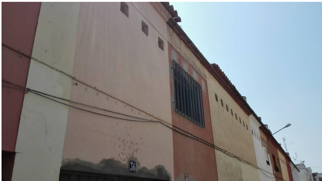
Ilustración 28. Desperfectos en cubiertas de teja zona garajes.
