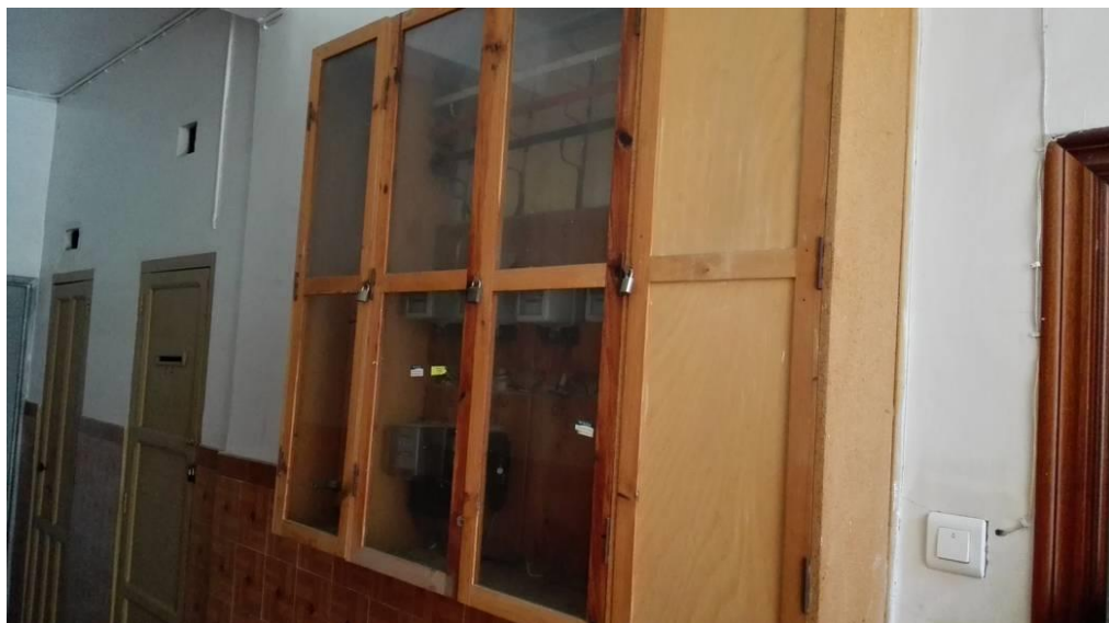
Ilustración 19. Cuadro de contadores en zaguán planta baja.
