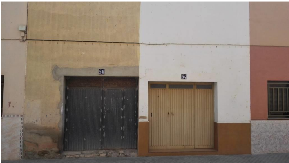
Ilustración 22. Humedades por falta de zocalada en fachada.
