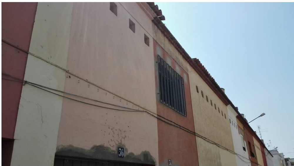
Ilustración 21. Deficiencias en pintura fachadas exteriores.
