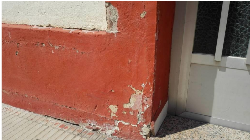
Ilustración 24. Desperfectos en zonas de acceso principal.
