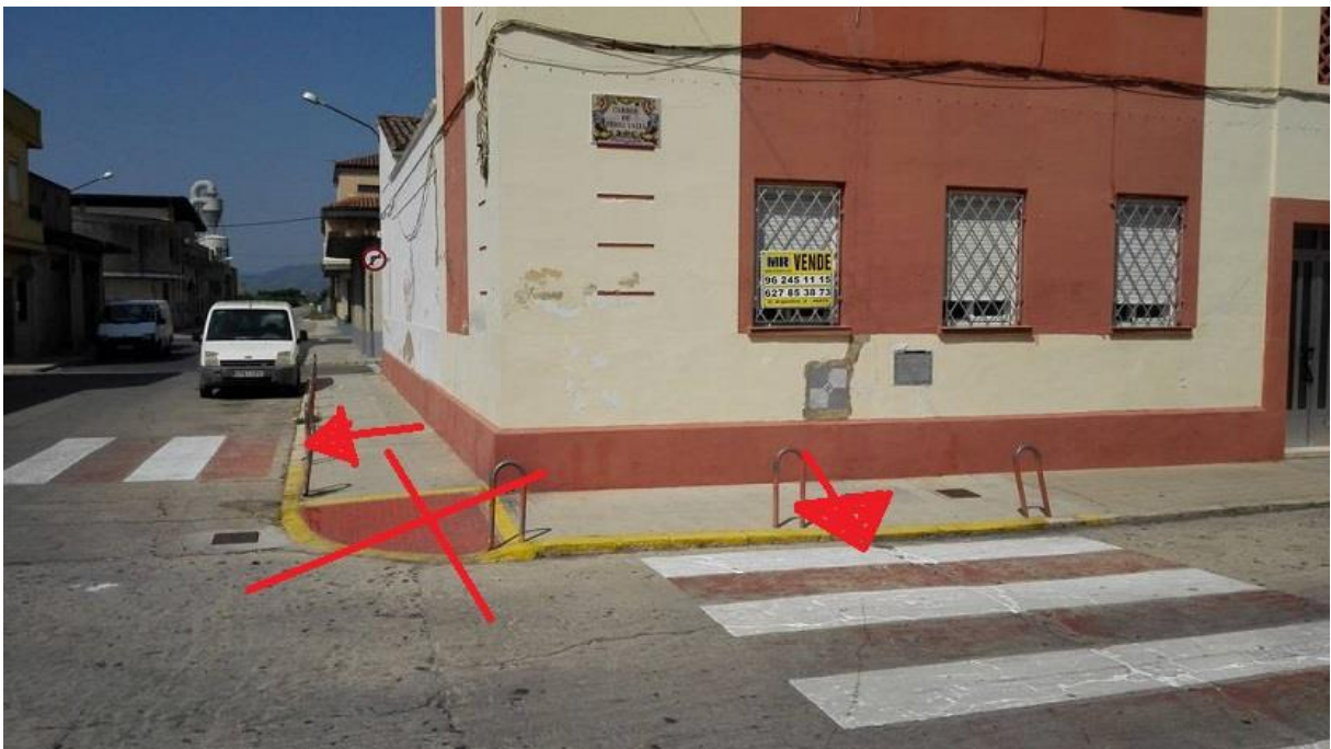
Ilustración 31. Rampas mal realizadas para acceso a pasos de peatones.
