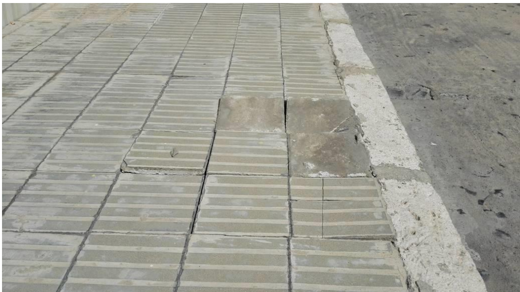
Ilustración 26. Deficiencias en acera perimetral.
