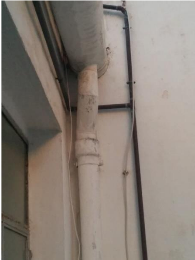
Figura 72: Tuberías de agua fría desde cubierta. 2015. Fuente propia.
