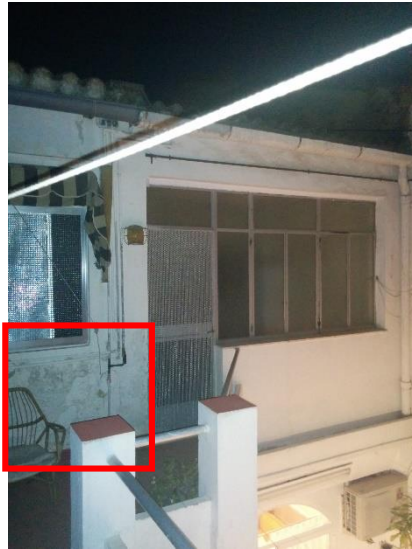
Figura 80: Localización humedad filtración. 2015. Fuente propia.
