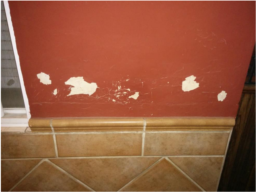
Figura 75: Humedad capilar fachada. 2015. Fuente propia.
