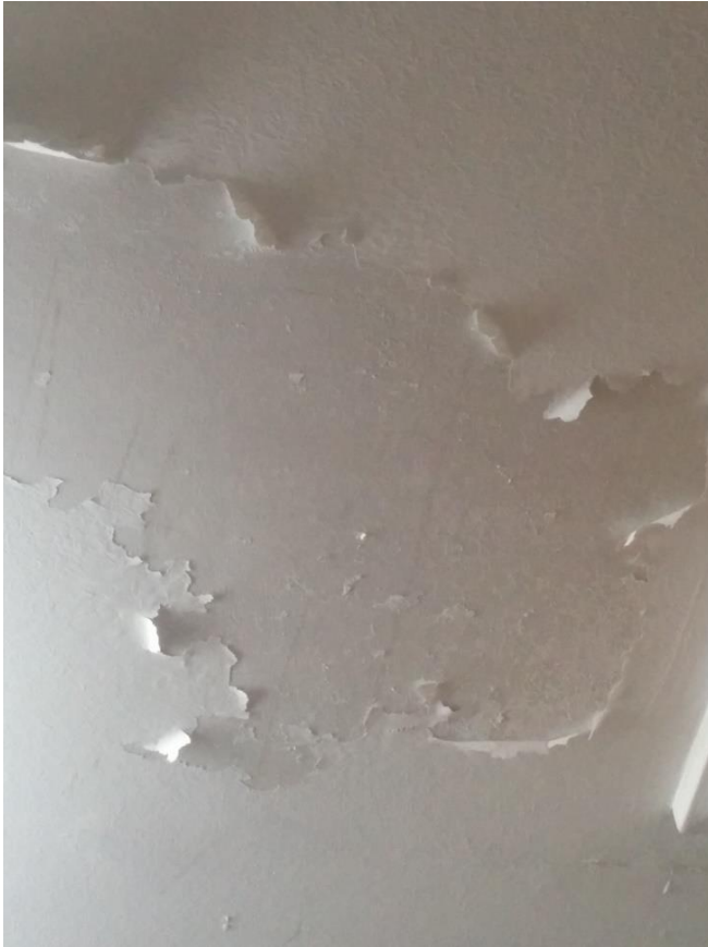
Figura 82: Desconchamiento del enlucido del techo. 2015. Fuente propia.
