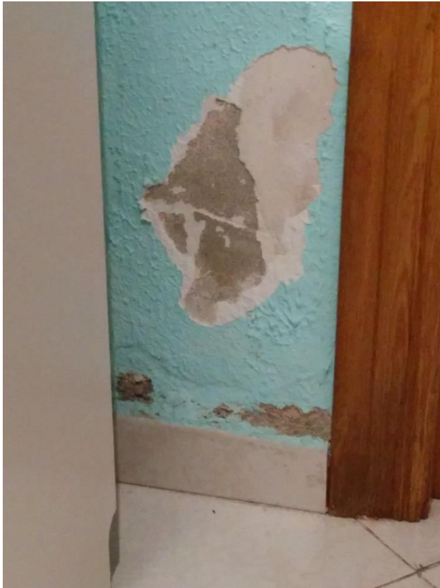
Figura 76: Humedad por capilaridad dormitorio 2. 2015. Fuente propia.
