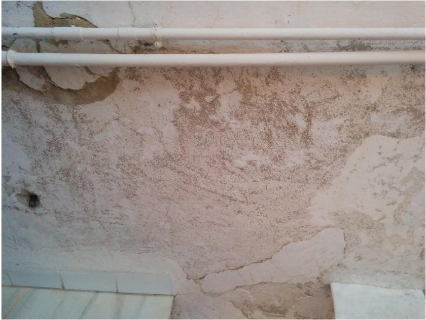
Figura 81: Desprendimiento del enlucido. 2015. Fuente propia.
