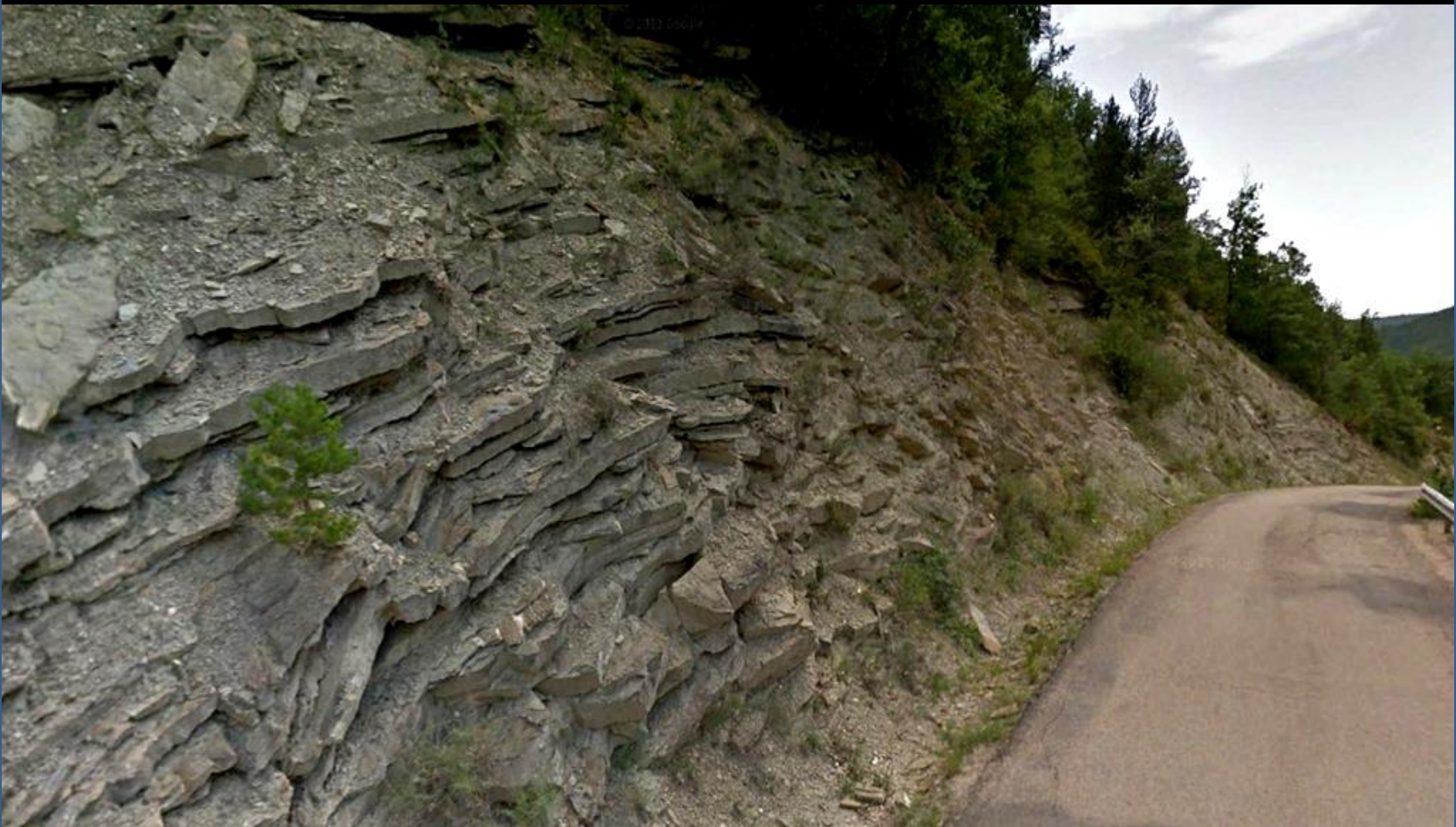
Detalle de anterior: Taludes metaestables en las lutitas y areniscas en facies turbidítica, del Luteciense, Eoceno Med. Terciario, plegadas y falladas. Carretera en el río Aurín al S de Acumuer, Huesca. NW Hoja de Biescas.
